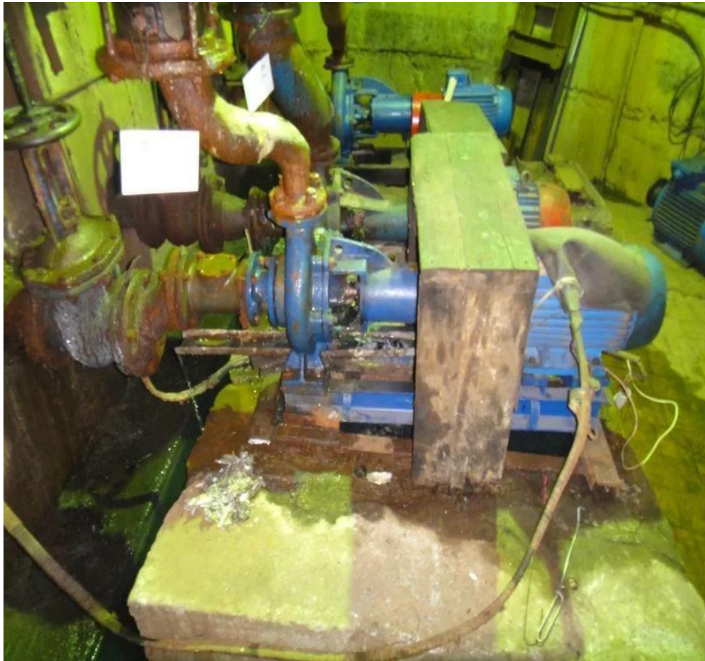
Рисунок – 3.2 Каналізаційна насосна станція
