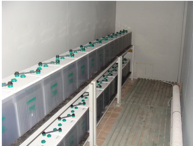
Рисунок 3.3 – Загальний вигляд акумуляторної батареї
