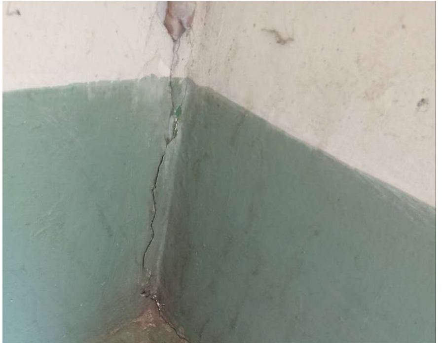
Рисунок 4.10 – Тріщини в стиках стінових панелей сходової клітини
