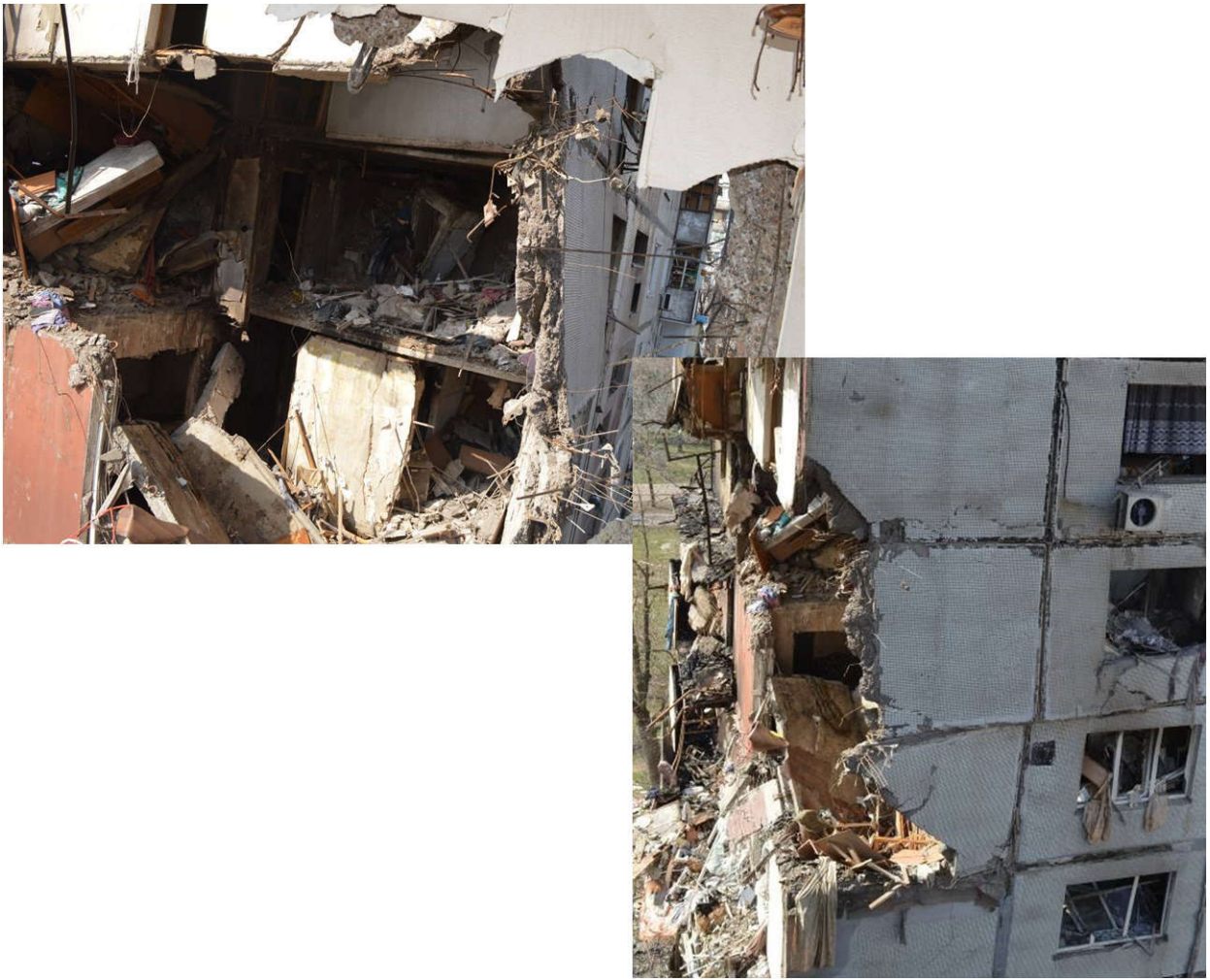
Рисунок 4.52 – Зруйновані конструкції по ряду «Г» та осі «IV»
