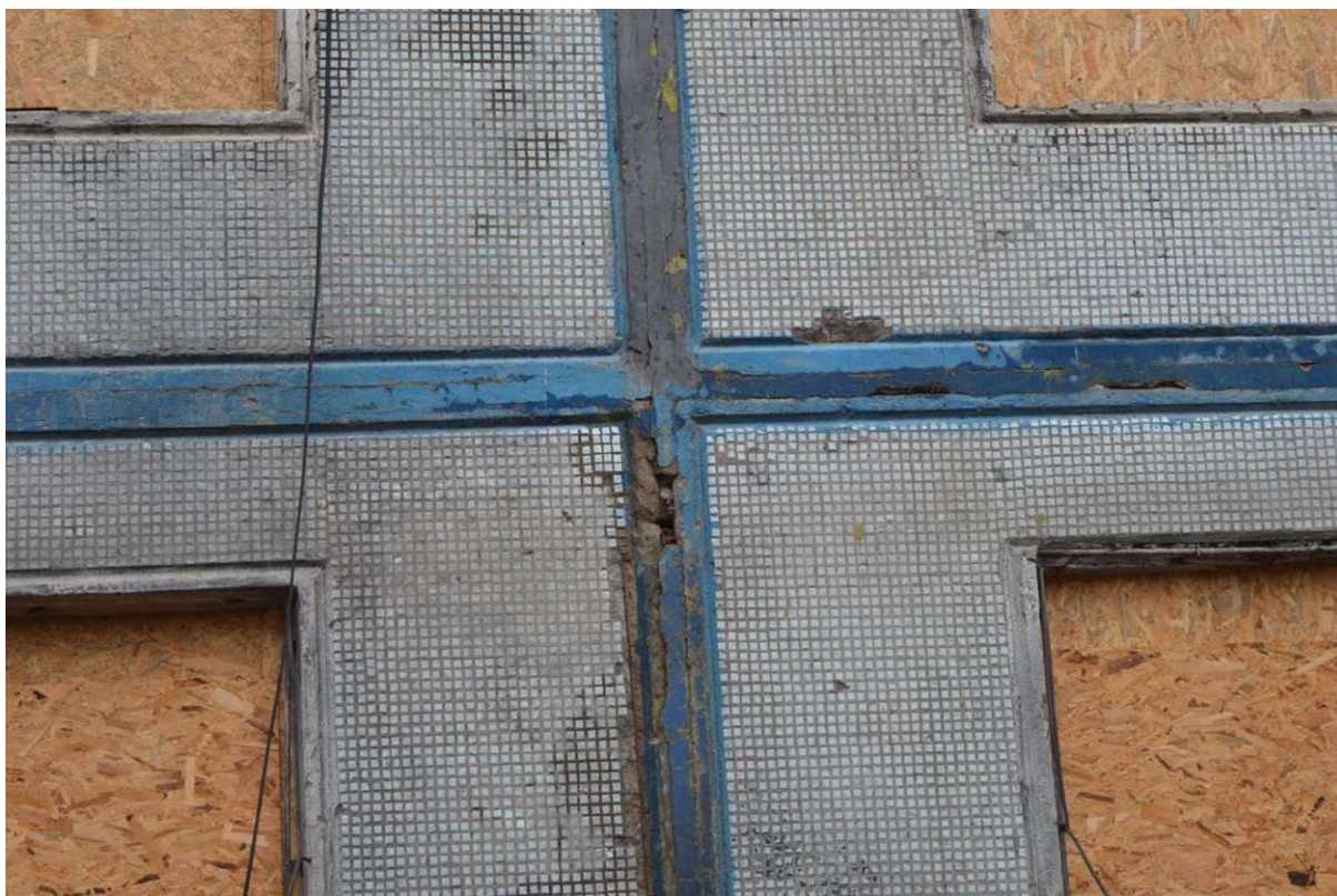
Рисунок 4.39 – Пошкодження швів між стіновими панелями:
