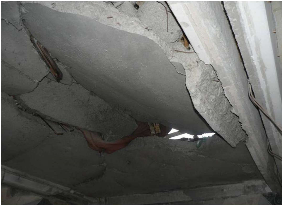
Рисунок 4.41 – Руйнація плит перекриття в рядах «В...Д» в осях «Ш/1...1/2»
