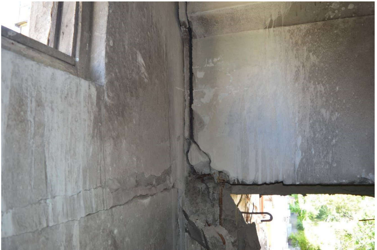
Рисунок 4.54 – Розкриття стиків, утворення тріщин в стиках панелей сходової клітини
