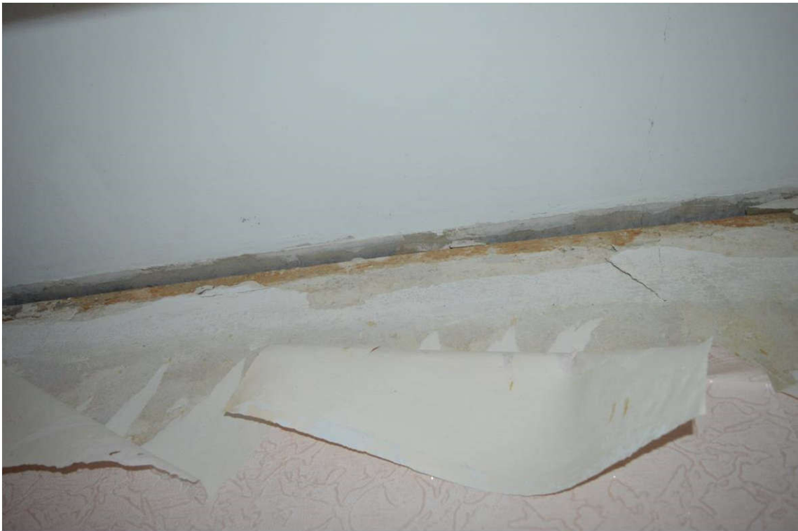
Рисунок 4.55 – Пошкодження, зміщення перегородок внаслідок дії вибухової хвилі в квартирі № 15
