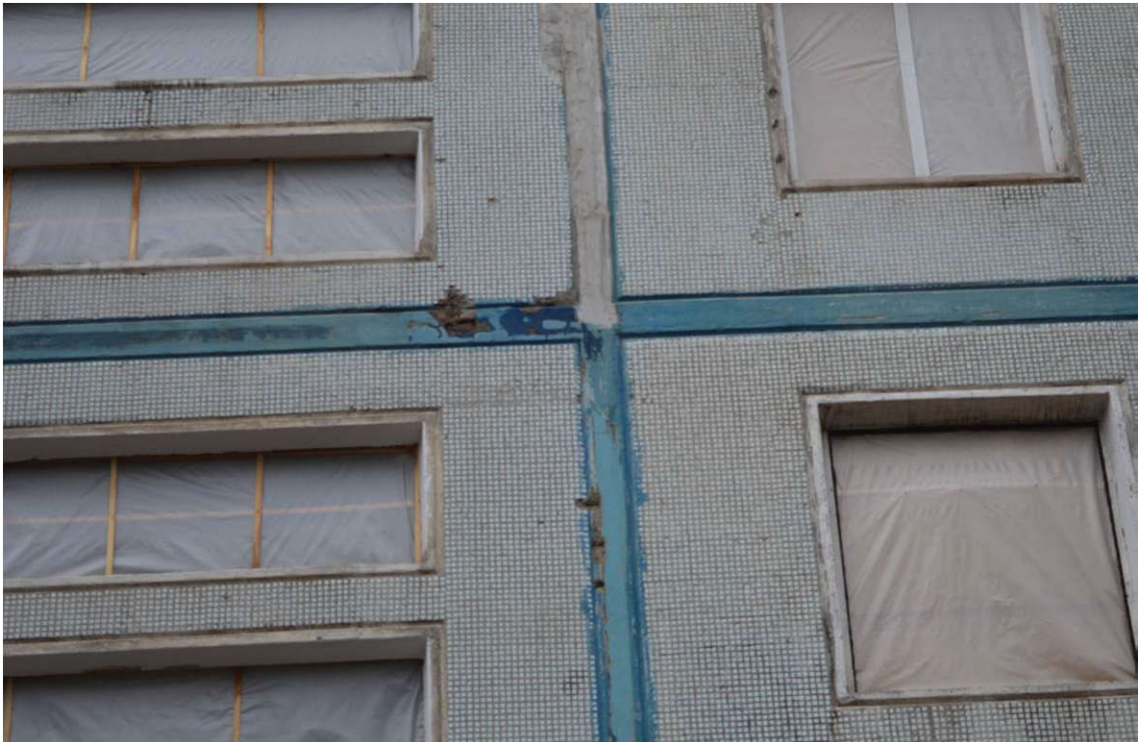
Рисунок 4.21 – Руйнація фактурного шару зовнішніх стінових панелей
