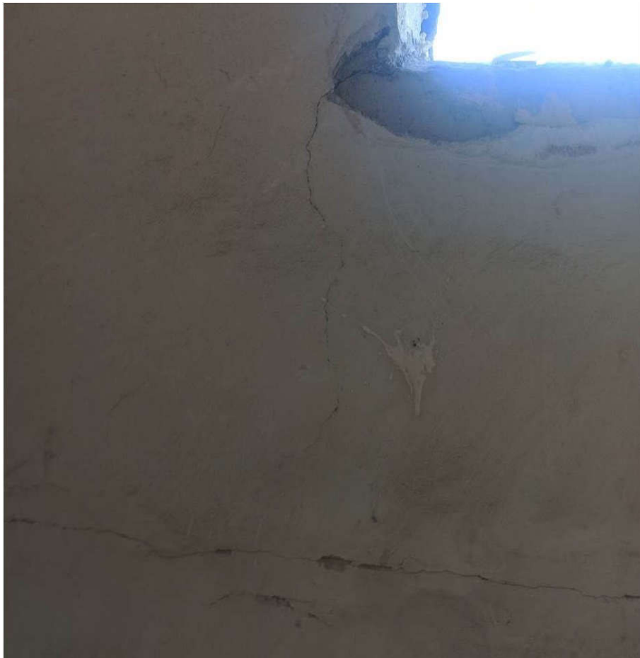
Рисунок 4.9 – Тріщини в стінах на сходовій клітині, восьмий поверх
