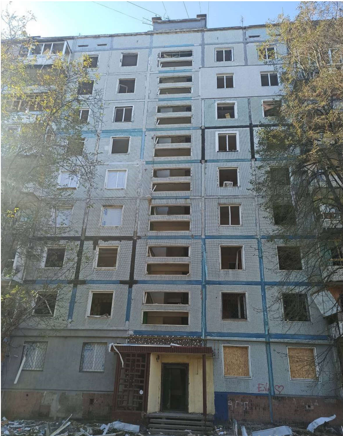
Рисунок 4.13 – Зовнішній вигляд блок-секції № 2 будівлі об'єкта (станом на жовтень 2022р.)
