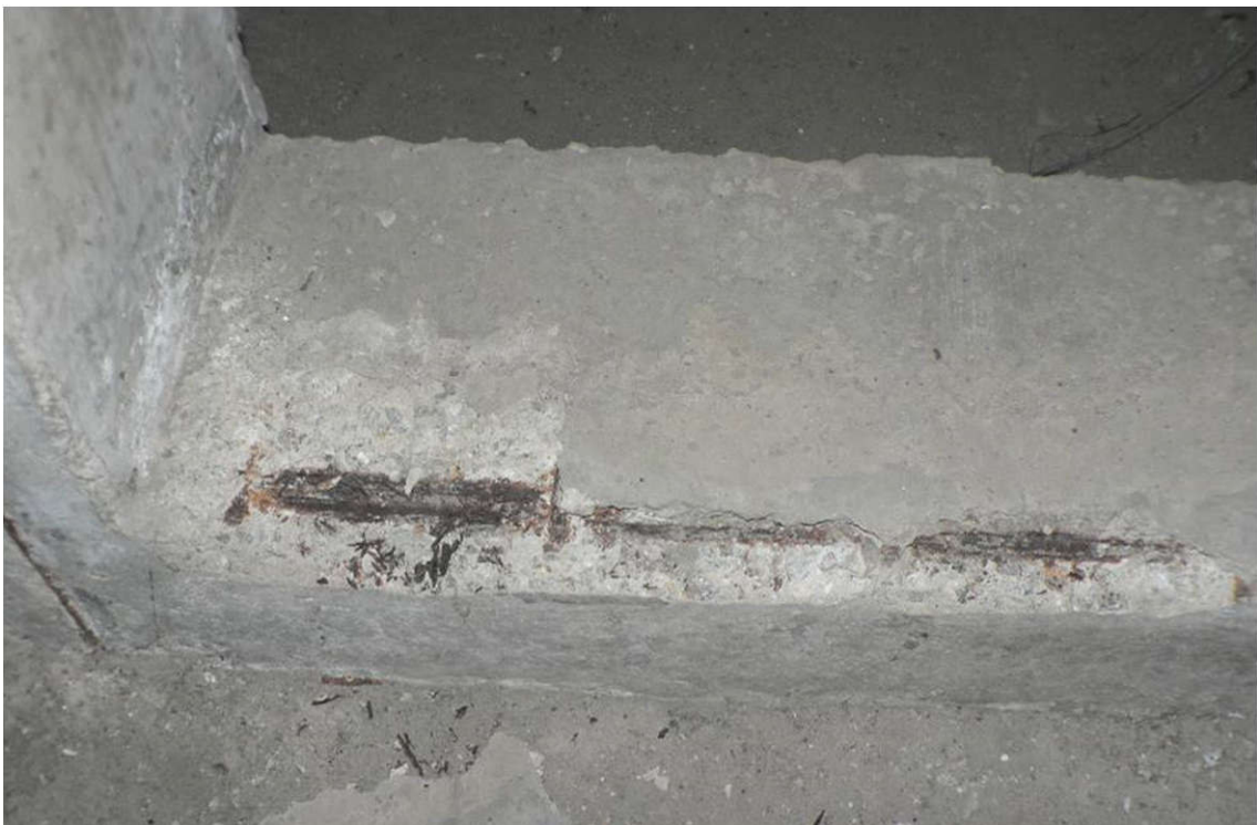
Рисунок 4.19 – Корозія арматури та сколи бетону на стінах технічного підпілля по ряду «В» в осях «5...VI/6»
