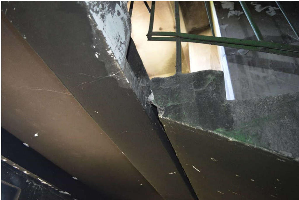
Рисунок 4.64 – Пошкодження сходів в районі п'ятого поверху
