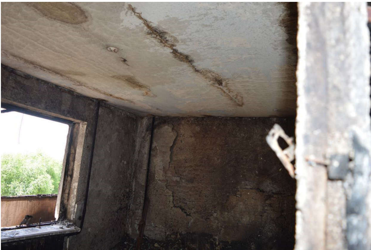
Рисунок 4.58 – Відшарування керамзитобетону зовнішніх стінових панелей та пошкодження плит перекриття внаслідок дії високих температур та відкритого полум'я в кв. № 14;
