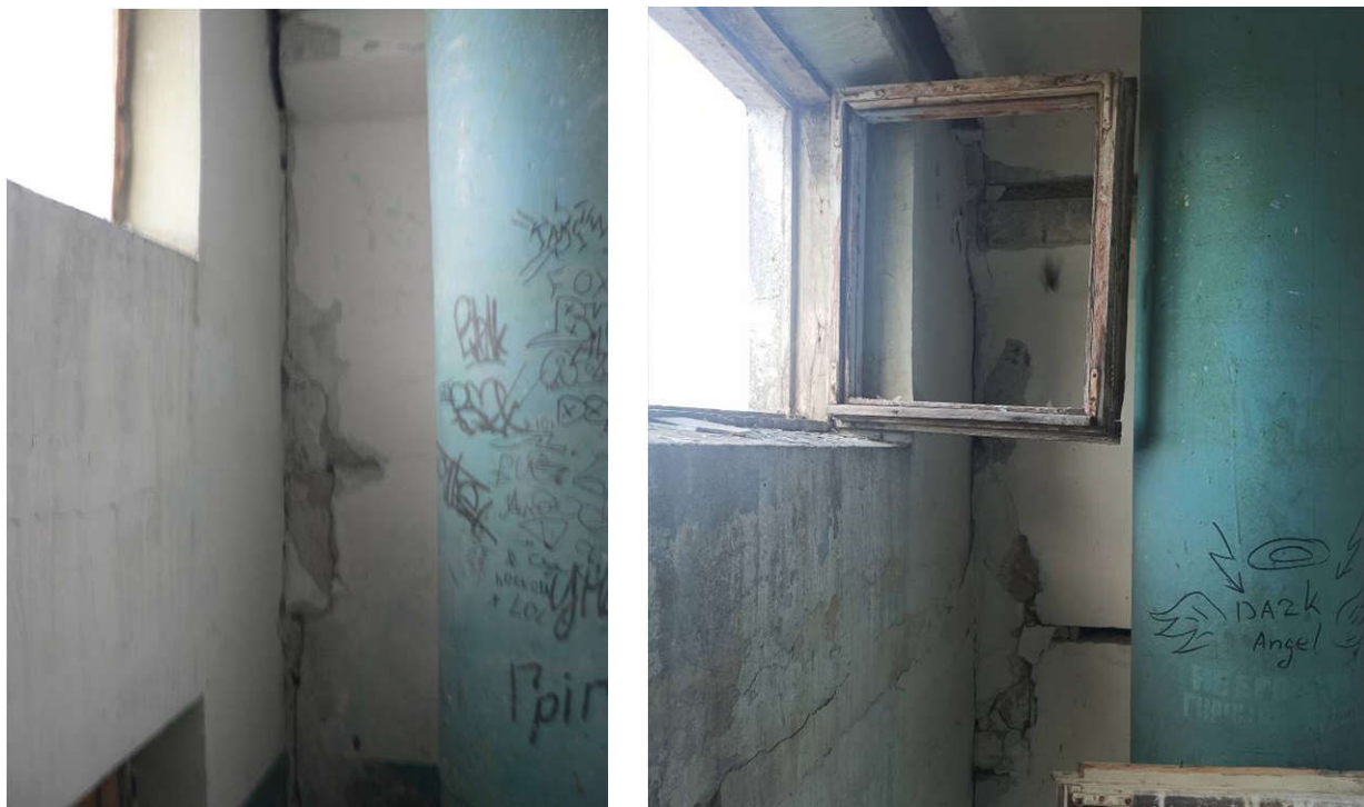
Рисунок 4.38 – Пошкодження стиків між панелями по ряду «Д» в осях «3...4»
