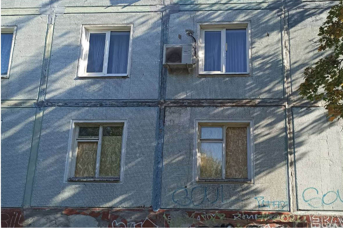
Рисунок 4.11 – Тріщини в стиках зовнішніх стінових панелей
