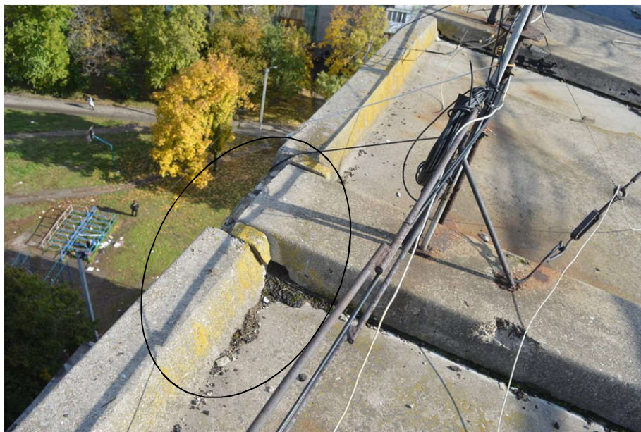
Рисунок 4.12 – Пошкодження плит покриття безрулонної покрівлі:
