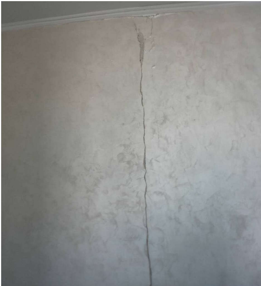
Рисунок 4.20 – Тріщина в швах між стіновими панелями в квартирі № 45
