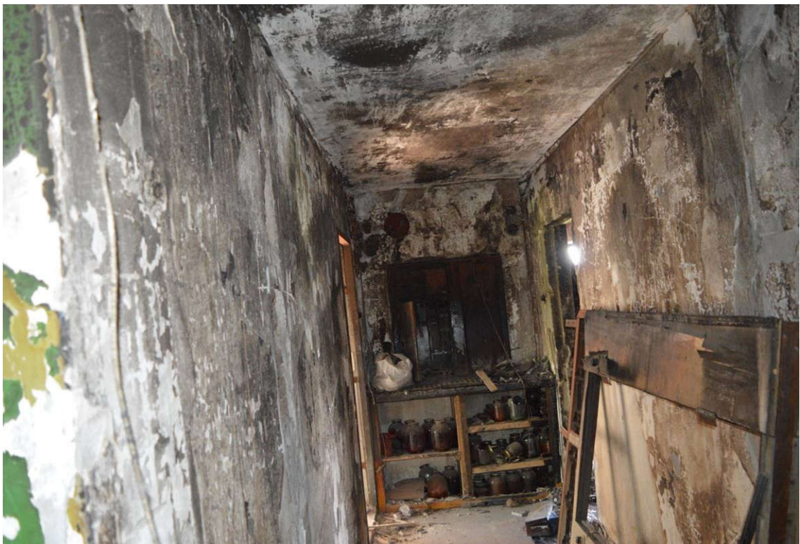
Рисунок 4.59 – Пошкодження внутрішніх стінових панелей коридорів внаслідок дії високих температур та відкритого полум'я: а) четвертий поверх; б) п'ятий поверх
