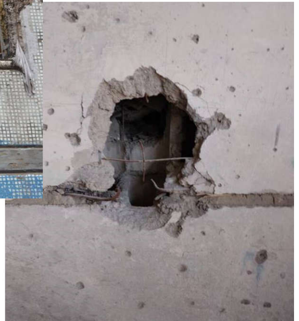
Рисунок 4.46 – Пошкодження панелей: а) стиків панелей; б) панелі уламками боєприпасу
