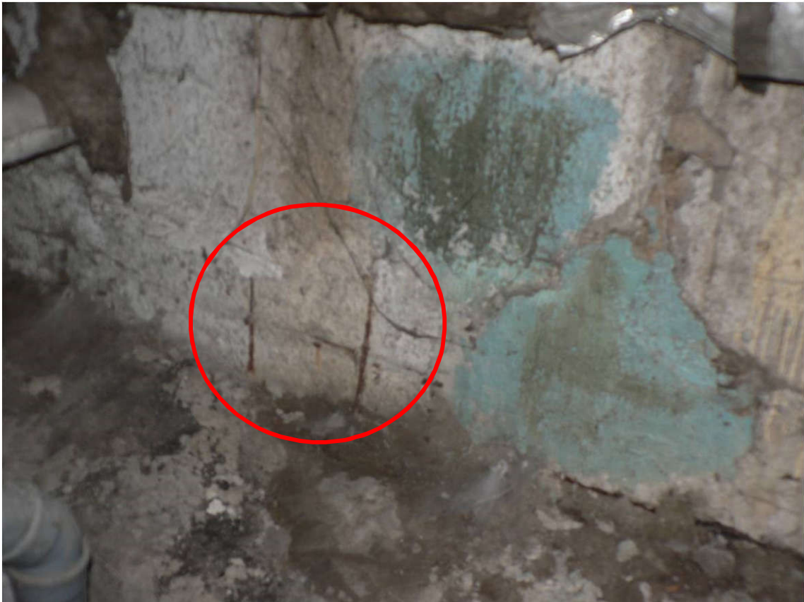
Рисунок 4.8 – Корозія арматури на стінах технічного підпілля по ряду «Д» в осях «4...5»
