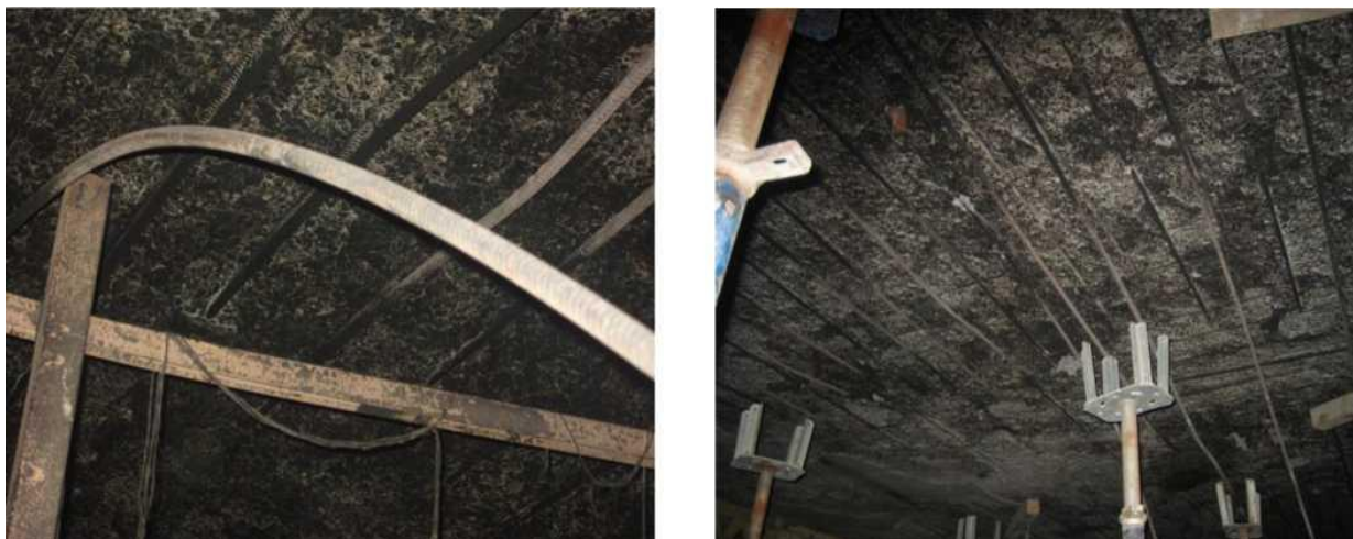
Рисунок 3.1 - Обвалення захисного шару бетону перекриття 2-го поверху, відшаровування і деформація арматури нижньої етки
