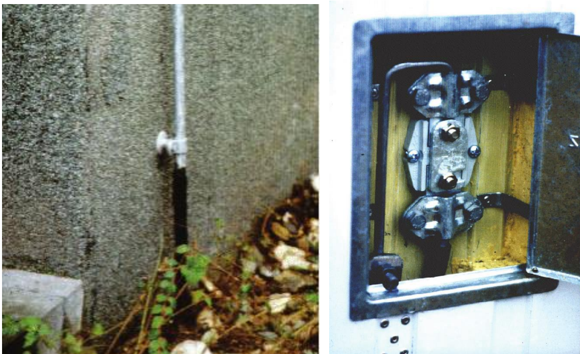
Рисунок Б.6 – Захист від корозії точки з'єднання струмовідводу та заземлювача; розміщення контрольної точки з'єднання у стіні
