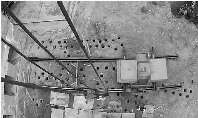
Рисунок 3.8 – Вдавлювання палі координатним способом (варіант К2) з дневної поверхні із застосуванням агрегатно-модульної системи на об'єкті компанії «ЗАРС» по вул. Пироговська, 2, в Одесі
