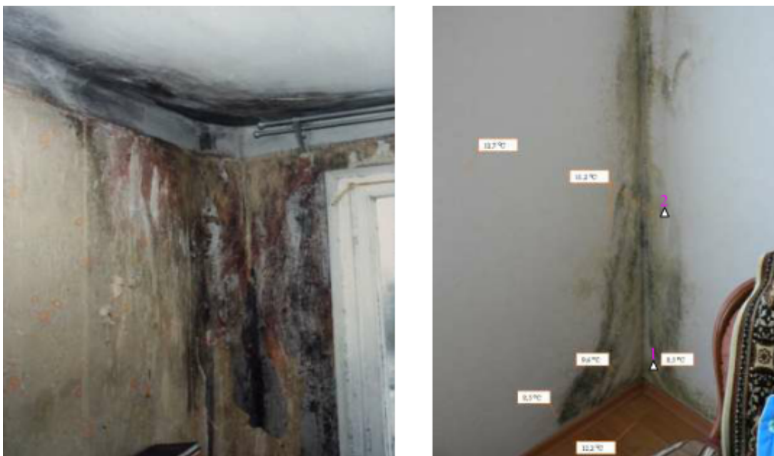
Рисунок 1.2 - Стан ізоляції зовнішніх стін у житлових приміщеннях будинків перших масових серій
