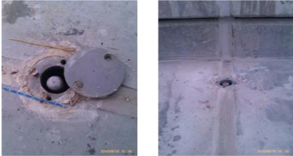
Рисунок 3.5 – Загальний вигляд пунктів мережі S36, S45 між складками нижнього ярусу трибун на конструкції ригелю
