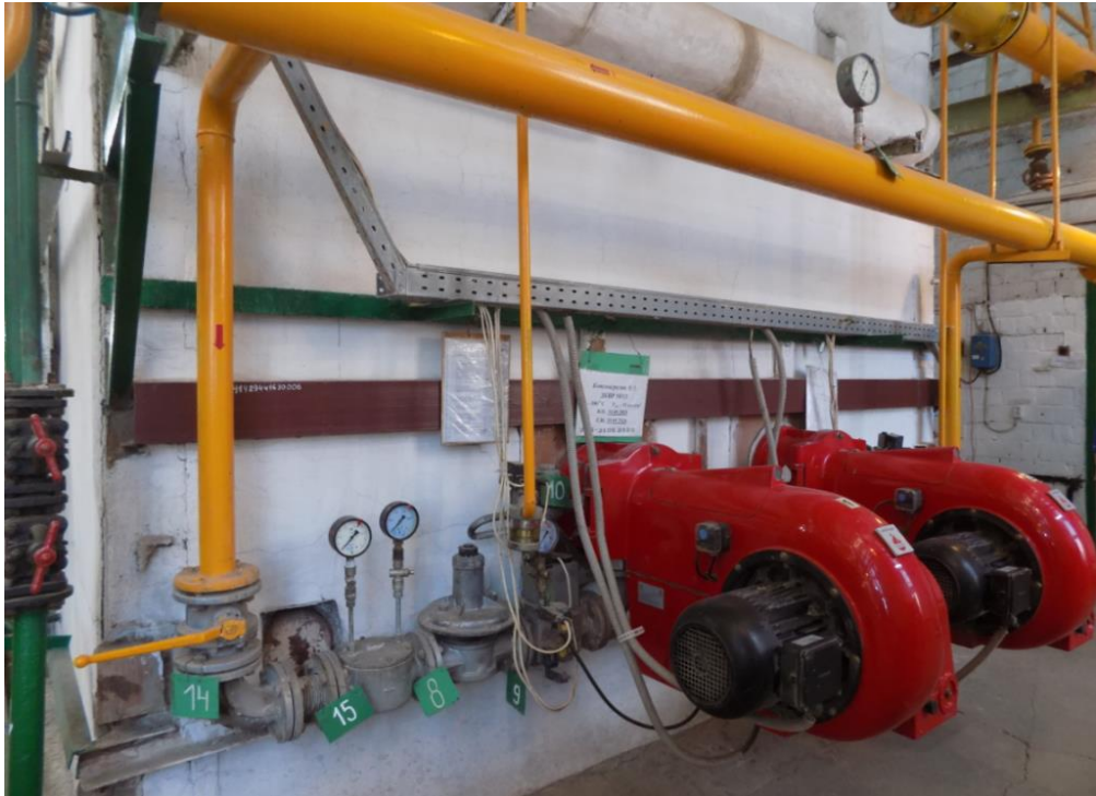
Рисунок 2.2 – Котел ДКВр 10-13 з пальниками Weishaupt
