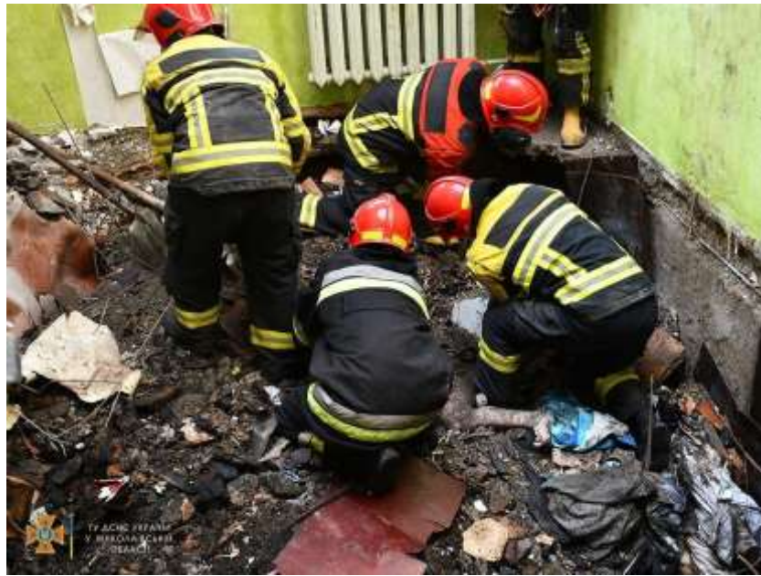
Рис. 2.12. Проведення робіт з деблокування тіла загиблого з під уламків будівлі
