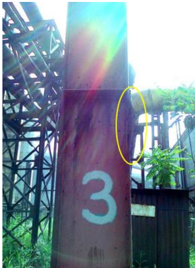
Рисунок 3.7 - Механічне ушкодження полиці опори К3, по осі 3 - погнутість f=35\text{мм} , L=300\text{мм} . Профіль траси 4-7. Категорія ушкодження по [34] - Б, група 6.2, таблиця 10
