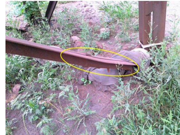
Рисунок 3.9 - Механічне ушкодження розкошу грат опори К- 2, по осі 2, погнутість f=20\text{мм} , L=1000\text{мм} . Профіль траси 2-7. Категорія ушкодження по [34] - Б, група 6.1, таблиця 10
