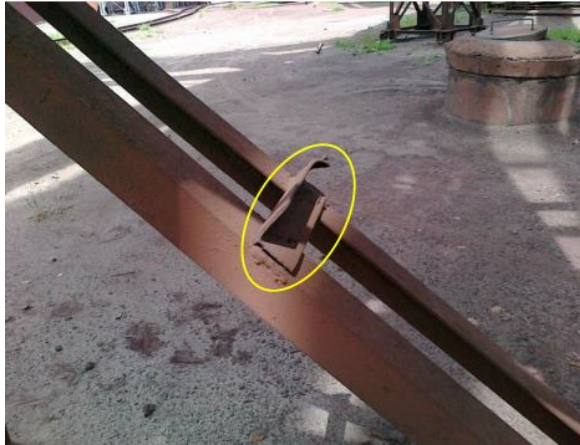
Рисунок 3.14 - Руйнування зварного шва кріплення куточка грат опори К-4а по осі 4; смалковка полиці куточка грат опори на величину f=20 мм. Профіль траси 2-7. Категорія ушкоджень по [34] - А, група 4.12; Б, група 6.9, таблиця 10
