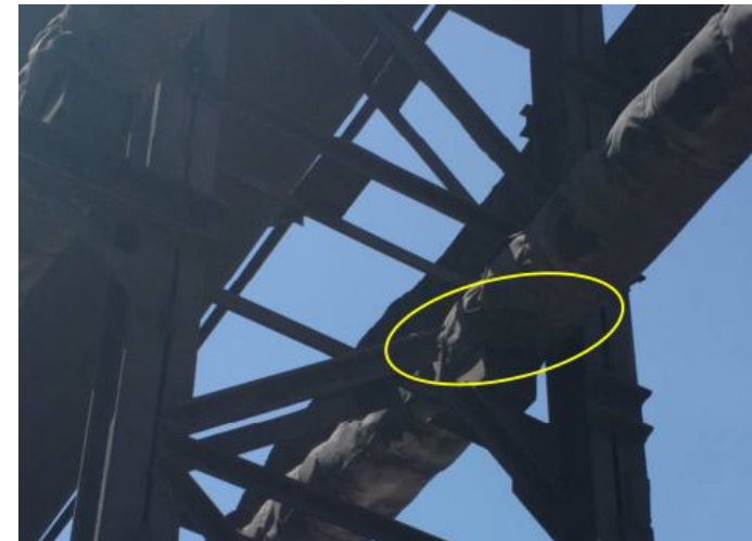
Рисунок 3. 21 - Виріз ділянок розкосу опори K13 по осі 446. Профіль траси 433-455. Категорія ушкодження по [34] - А, група 1.1, таблиця 10
