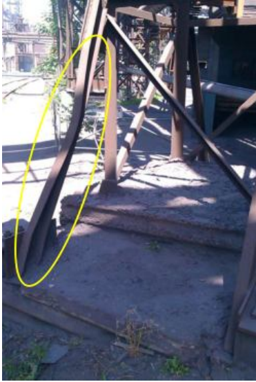
Рисунок 3.22 - Механічне ушкодження підкосу опори K21 по осі 454 на ділянці L=1500мм. Профіль траси 433-455. Категорія ушкодження по [34] – Б, група 6.1, таблиця 10
