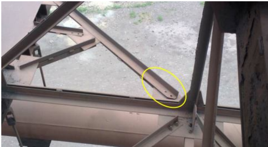
Рисунок 3.3 - Руйнування зварного шва кріплення елемента траверси ферми до фасонки, ферма Ф- 4 в осях 4-5. Профіль траси 2-7. Категорія ушкодження по [34] - А, група 4.12, таблиця 10
