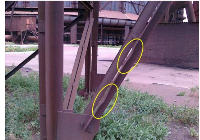
Рисунок 3.12 - Смалковка полиці куточка вертикального зв'язку підкосу опори К- 2 по осі 2, f=10\text{мм} , L=200\text{мм} . Профіль траси 2-7. Категорія ушкодження по [34] – В, група 6.9, таблиця 10
