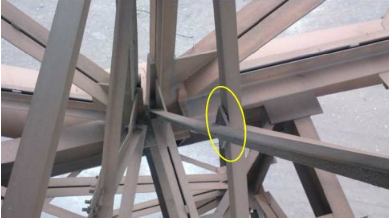
Рисунок 3.6 - Руйнування зварного шва вузлового з'єднання елементів вертикальний зв'язку пролітної будови до фасонки, по осі 5. Профіль траси 2-7. Категорія ушкодження по [34] - А, група 3.1, таблиця 10
