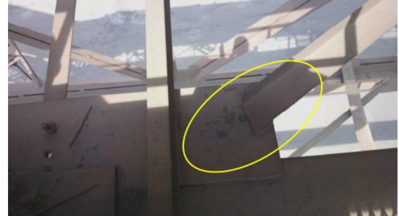
Рисунок 3.4 - Виріз ділянки горизонтального зв'язку по верхніх поясах ферм Ф- 5 (механічне ушкодження). Недостатня довжина зварного шва кріплення зв'язки до фасонки. Профіль траси 2-7. Категорія ушкодження по [34] - А, групи 4.12; 4.13, таблиця 10
