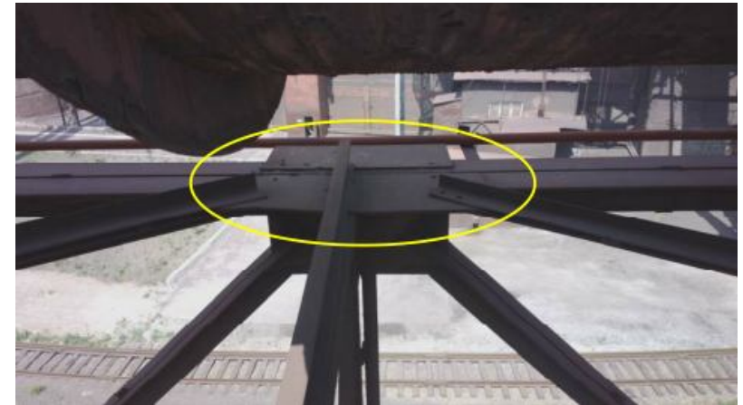
Рисунок 3.5 - Механічне ушкодження - погнутість вузлової фасонки ферми Ф- 5 на величину \alpha \approx 2 . Профіль траси 2-7. Категорія ушкодження по [34] - Б, група 6.6, таблиця 10
