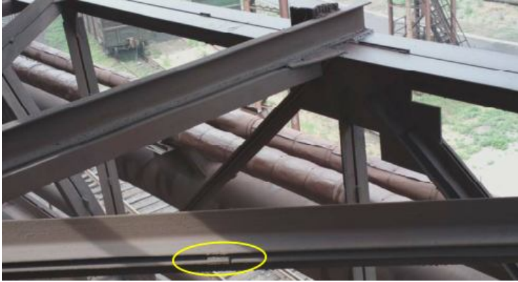
Рисунок 3.2 - Характерне ушкодження - руйнування зварних швів кріплення проміжних прокладень складових елементів з куточків (нижній пояс ферми, горизонтальні зв'язки по верхніх поясах пролітної будови). Профіль траси 2-7. Категорія ушкодження по [34] - А, група 4.12, таблиця 10
