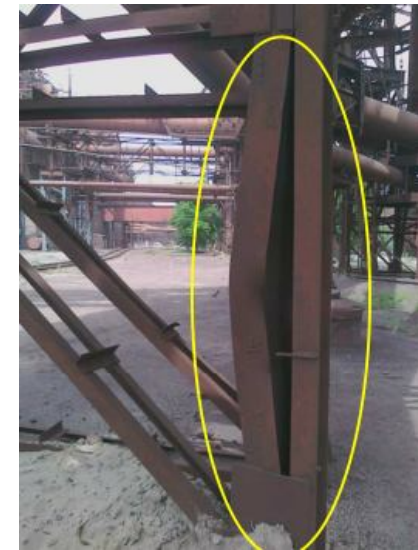
Рисунок 3.13 - Механічне ушкодження гілки опори з подальшим підсиленням, опора К-4а вісь 4. Профіль траси 2-7
