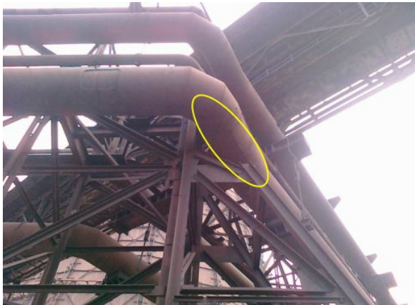
Рисунок 3.11 - Механічне ушкодження - виріз ділянки підкосу опори К- 2 по осі 2. Профіль траси 2-7. Категорія ушкодження по [34] - А, група 1.1, таблиця 10
