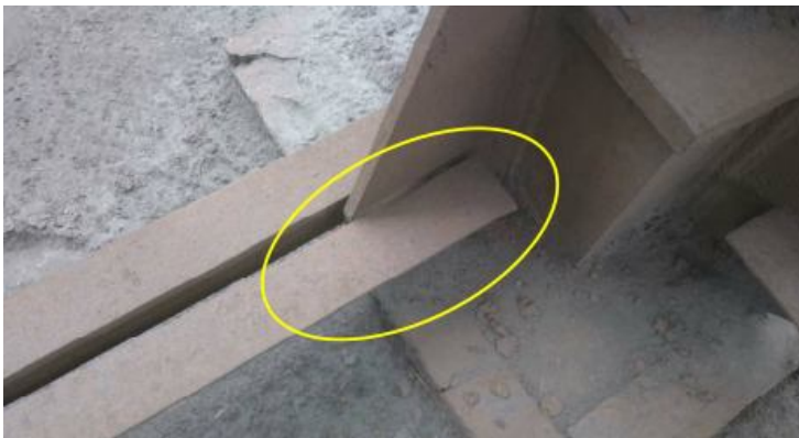
Рисунок 3.15 - Руйнування зварного шва кріплення розпірки грат до опори К- 5 вісь 5. Профіль траси 2-7. Категорія ушкодження по [34] - А, група 4.11, таблиця 10
