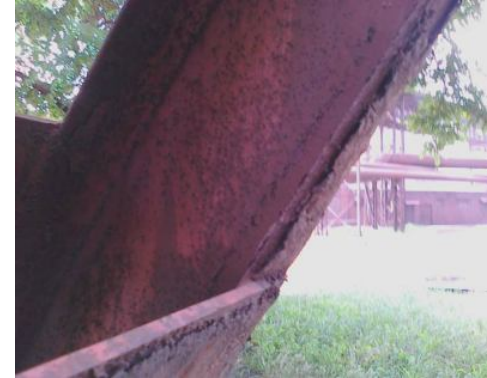
Рисунок 3.8 - Характерне ушкодження - руйнування антикорозійного покриття конструкції опори естакади. Корозія до 3% від площі поперечного перетину елементу. Категорія ушкодження по [34] - В, група 12.2, таблиця 10
