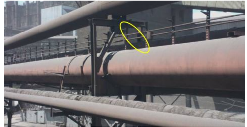
Рисунок 3.20 - Виріз підкосу опори K11 по осі 444. Профіль траси 433-455. Категорія ушкодження по [34] - А, група 1.1, таблиця 10
