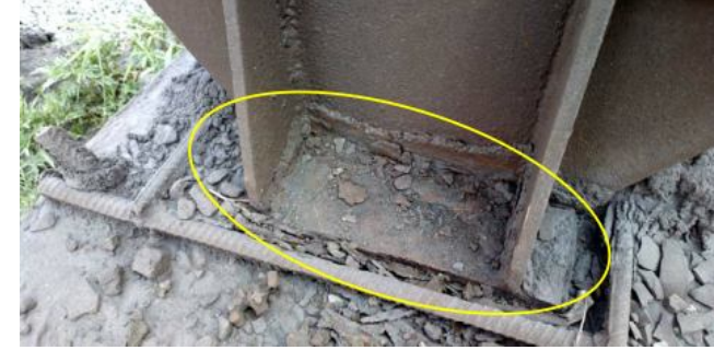
Рисунок 3.24 - Руйнування антикорозійного покриття опорної плити опори K22 по осі 455а. Корозія до 30% від площі поперечного перерізу елемента. Категорія ушкодження по [34] - В, група 12.2, таблиця 10
