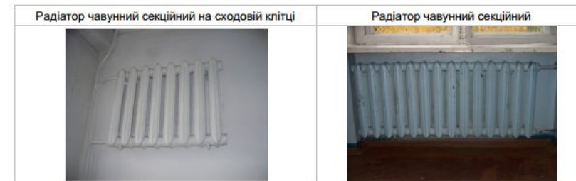
Рисунок 3.7 - Прилади опалення будівлі
