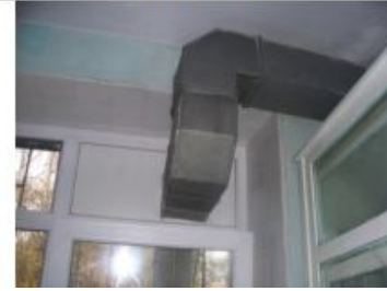
Витяжний вентиляційний канал в лабораторії на 1 поверсі
