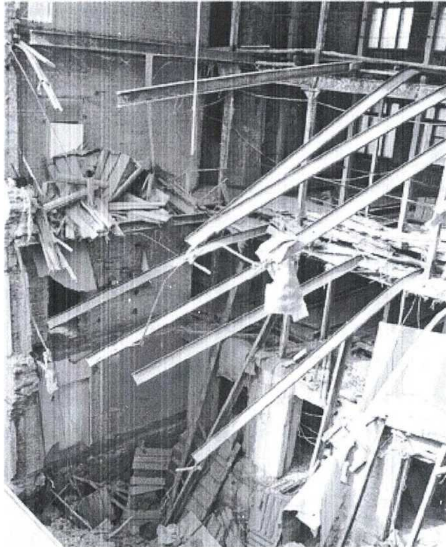
Рис. 2.3 Обвалення стіни і перекриттів 4-поверхового будинку, що реконструюється на Садовничиській набережній, при влаштуванні в ньому підвального приміщення
