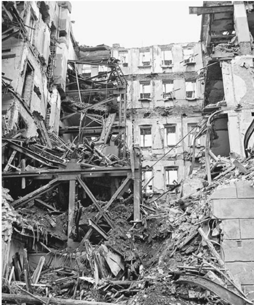
Рис.2.2 Обвалення при реконструкції 6-поверхової будівлі в Староконюшенному провулку
