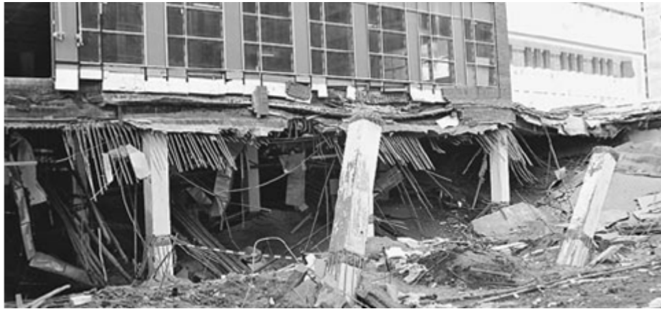
Рис. 2.1. Обвалення безбалкового перекриття підземної стоянки на вул.. Кожевнічеська
