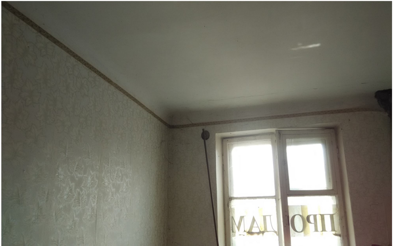
Рисунок 41 – Технічний стан приміщення першого поверху.
