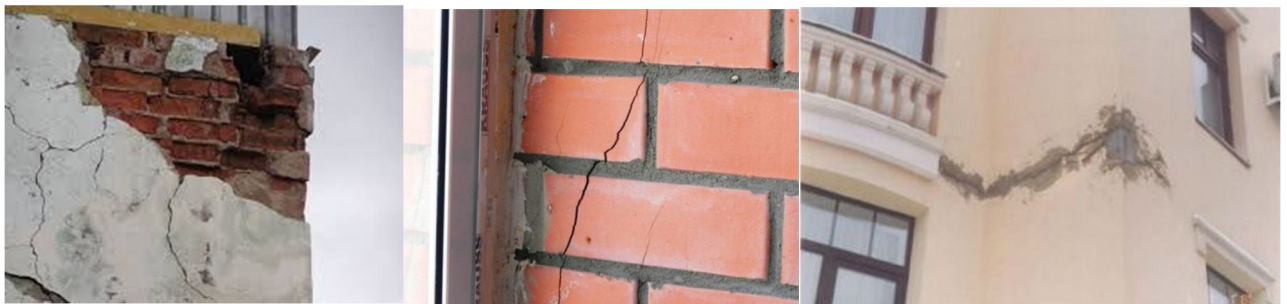
Рисунок 5 - Дефекти та пошкодження кладки стін
