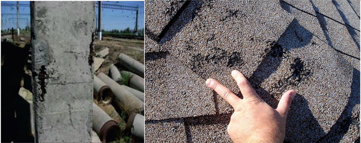
Рисунок 2 - Приклад дефектів будівельних конструкцій
