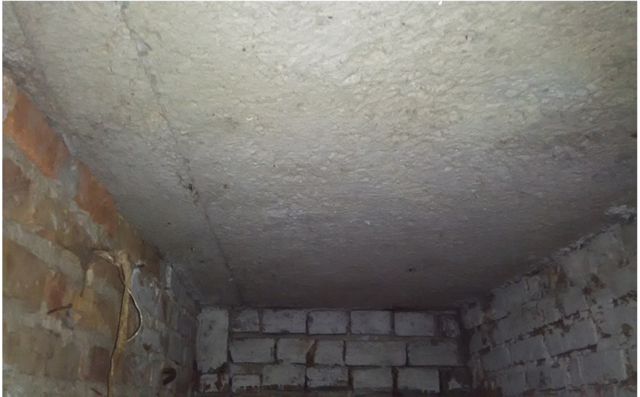
Рисунок 40 – Технічний стан залізобетонних плит перекриття у підвалі.
