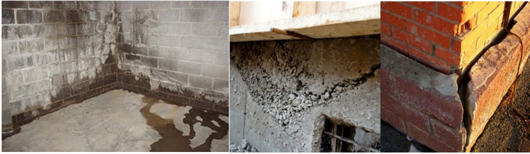
Рисунок 8 - Відсутність гідроізоляції стін
