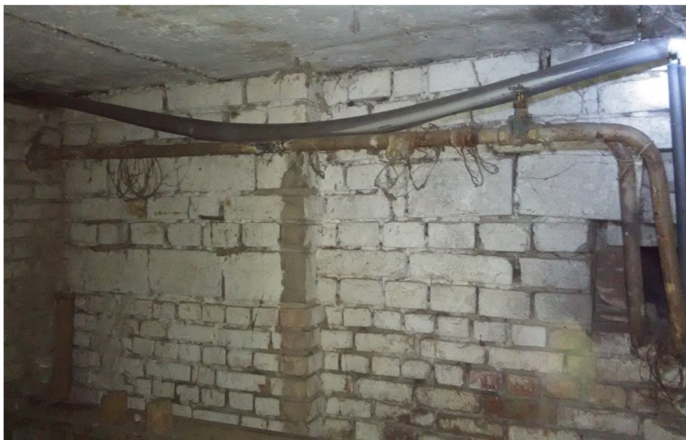
Рисунок 44 – Технічний стан приміщення підвалу, де передбачено демонтаж частини плити перекриття
