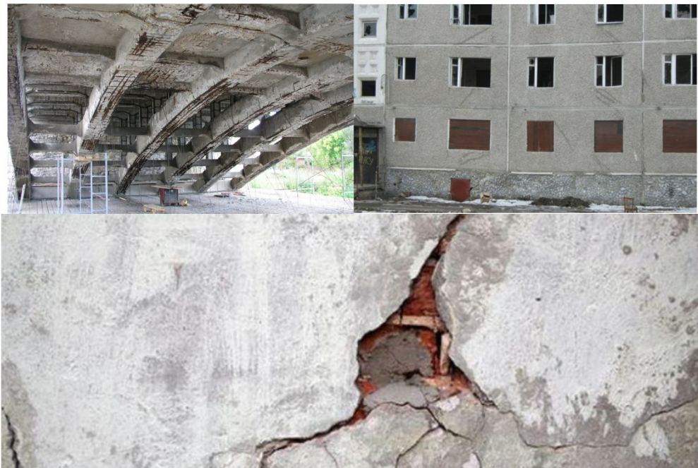
Рисунок 1 - Приклад дефектів будівель і споруд
