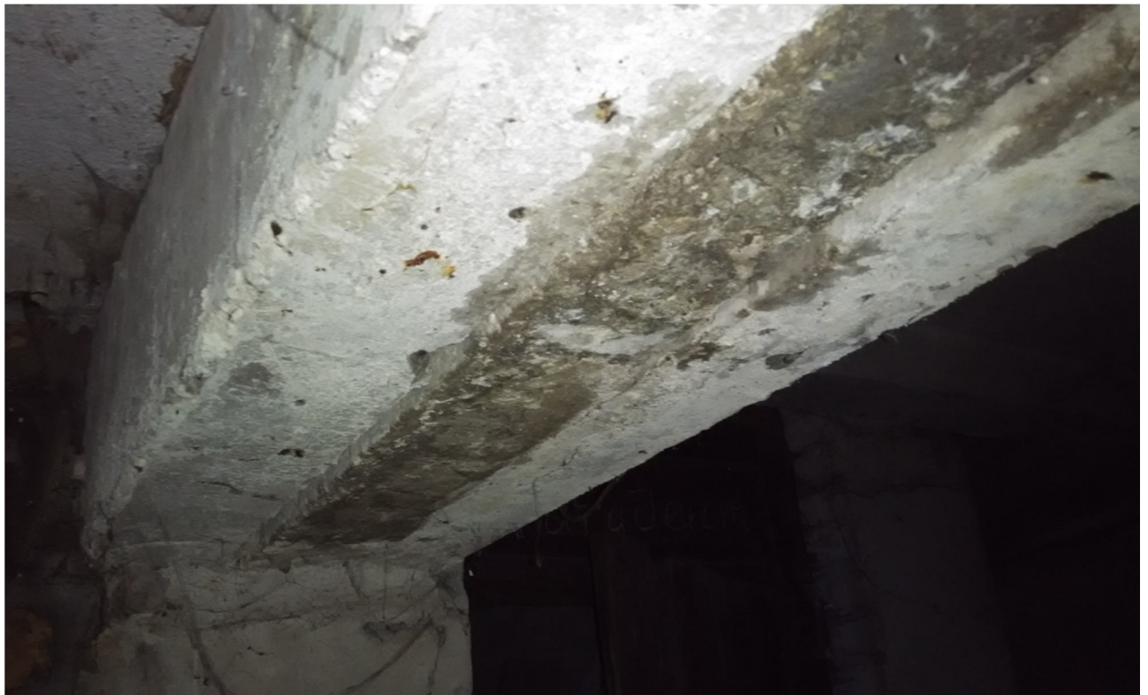
Рисунок 39 – Технічний стан залізобетонної перемички у підвалі.
