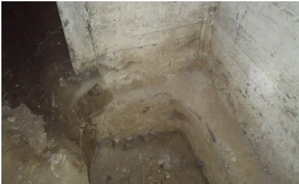
Рисунок 37 – Шурф фундаменту у підвалі біля зовнішньої поздовжньої стіни.
