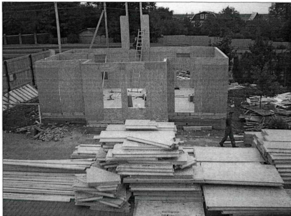
Рисунок 3.12 - Монтаж зовнішніх стінових панелей 1-го поверху з сендвіч-панелей 1,2 на м вручну, ланкою з 3-х робочих 2-го розряду в експериментальній технології
