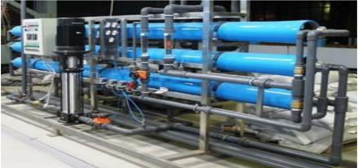
Рисунок 3.3- Двоступенчата установка зворотного осмоса
