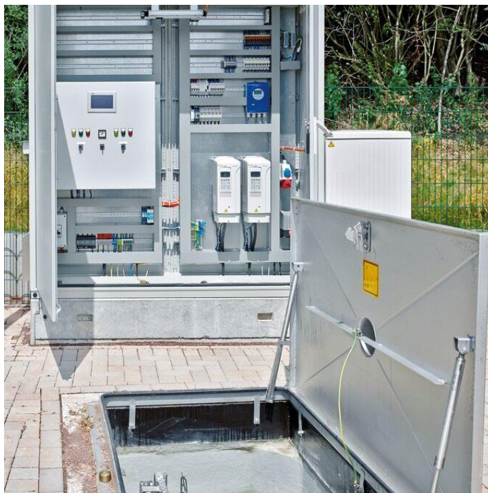
Рисунок 4.1 – Вид електричного ящика з промисловими контролерами.
