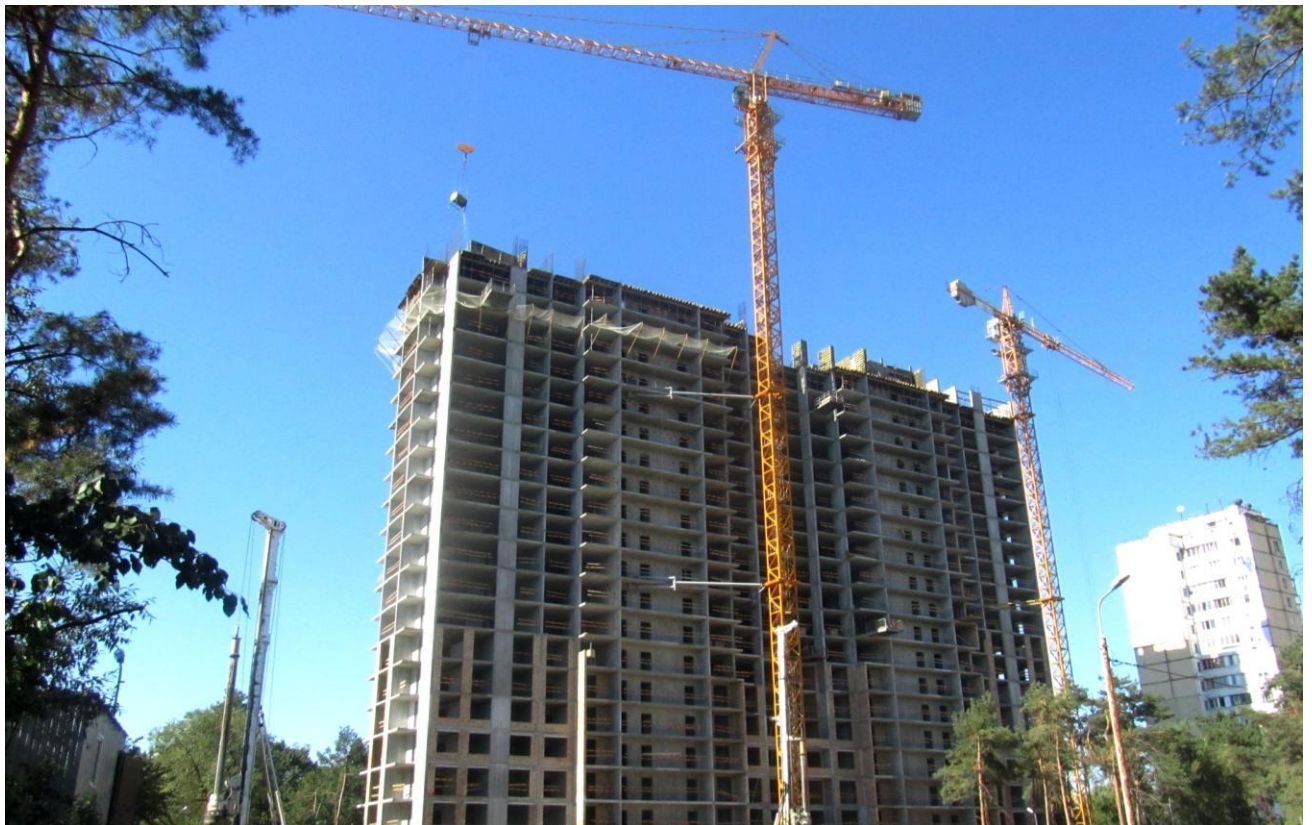
Рисунок 2.3 – Зведення каркасу будівлі за допомогою баштових кранів FO 23B та Potain MC 175B
