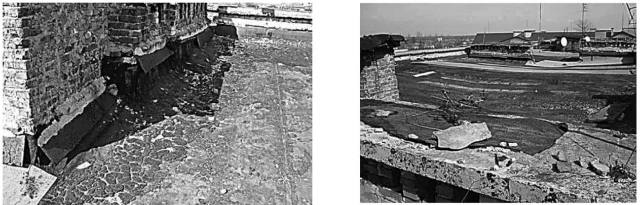
Рисунок 2.7 - Зовнішній вигляд покрівлі з рулонних матеріалів після тривалої експлуатації
