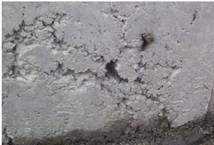
Рисунок 3.2 – Дефект бетону – нерівності з щебенивим наповнювачем
