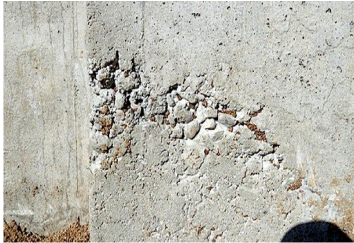
Рисунок 3.5 – Бетон пошкоджений спекою
