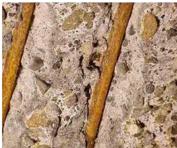
Рисунок 2.6 – Корозійні пошкодження бетону
