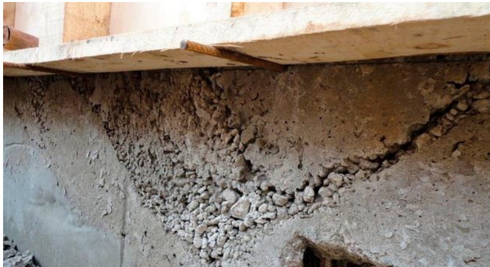
Рисунок 2.5 – Тріщини від силових впливів
