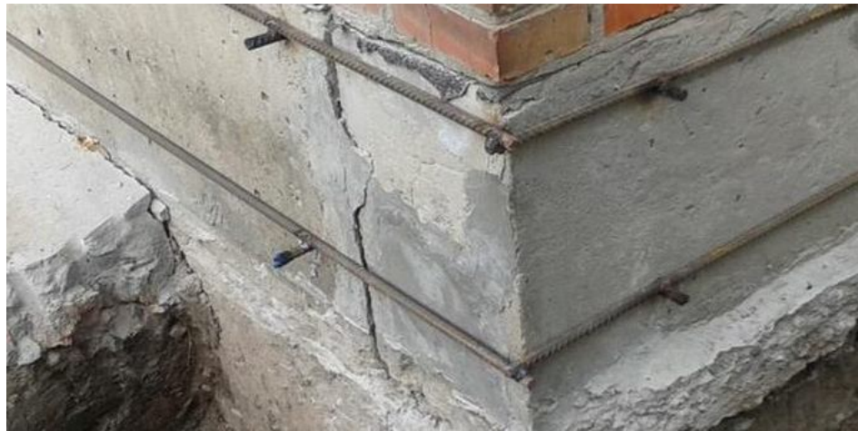
Рисунок 2.4 – Тріщини у фундаментах будівлі
