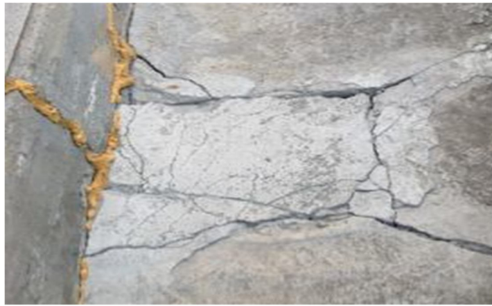
Рисунок 3.6 – Пошкодження нового бетону, який не був захищений від дощу
