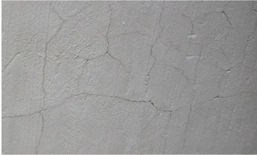
Рисунок 2.2 – Тріщини у фундаменті після заливки
