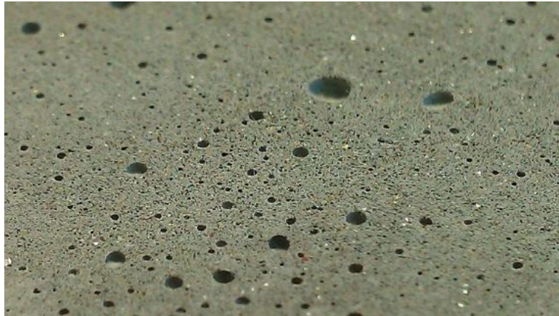
Рисунок 3.3 – Дефект бетону – наявність поверхневих раковин
