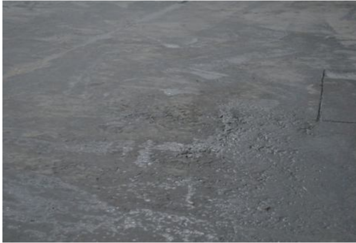
Рисунок 3.1 – Дефект бетону – нерівності з щебенивим наповнювачем
