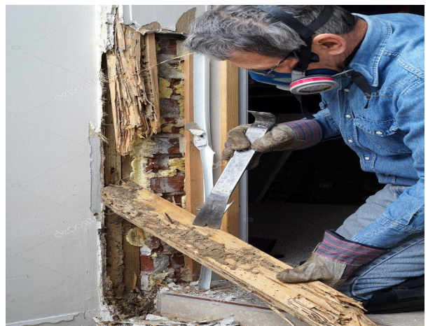
Рисунок 1.4 – Пошкодження конструкцій термітами
