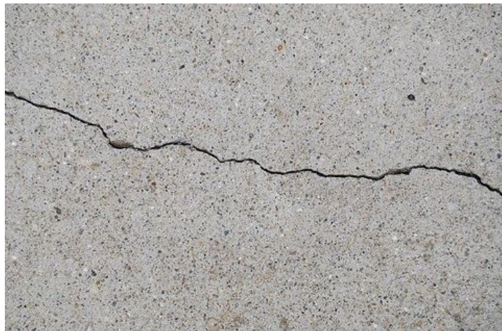
Рисунок 3.4 – Дефект бетону – видимі тріщини на поверхні
