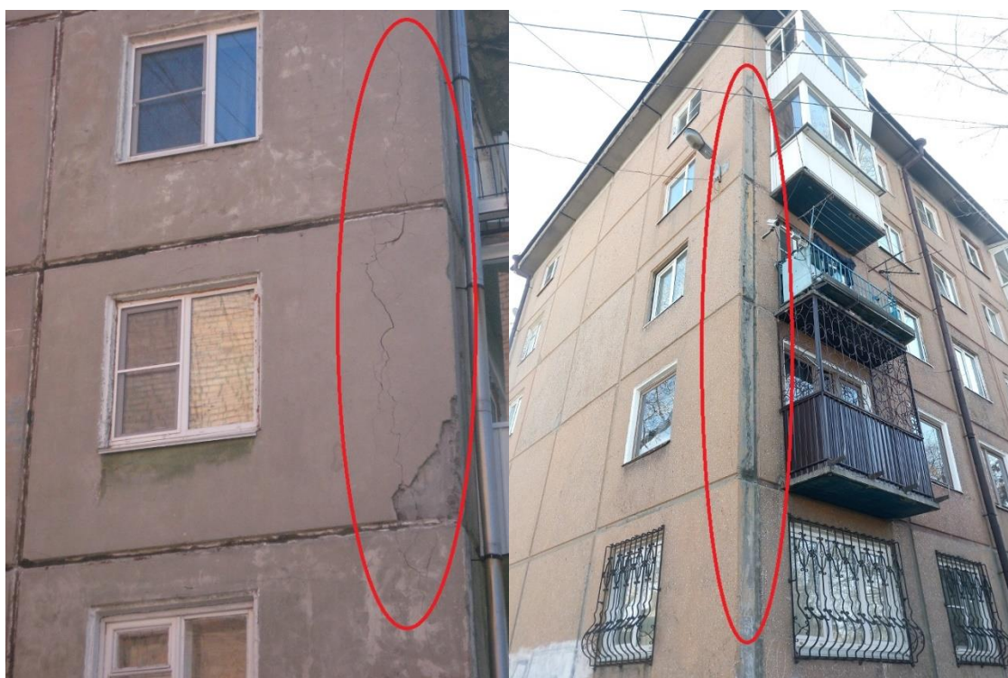
Рисунок 1.33 – Пошкодженні стінові панелі
