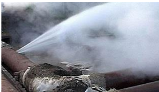
Рисунок 2.2 – Розрив трубопровід сірчаної кислоти
