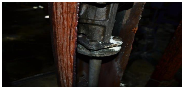
Рисунок 2.9 – Результати попадання кислоти на фланцеве з'єднання трубопроводу
