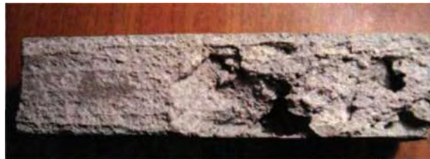
Рисунок 3.13 - Зразок торкрет-бетону при продуктивності торкрет-машини 4,8 м 3 / ч, відстані від сопла 1 м., Натягу тканини пневмоопалубки 25 кН / м
