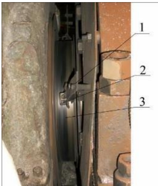
Заземлювальний пристрій турбогенератора
