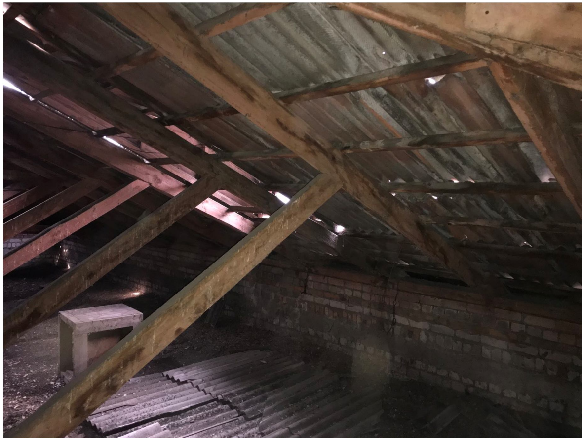
Рисунок 2.25 – Технічний стан кроквяних балок з підкосами.
