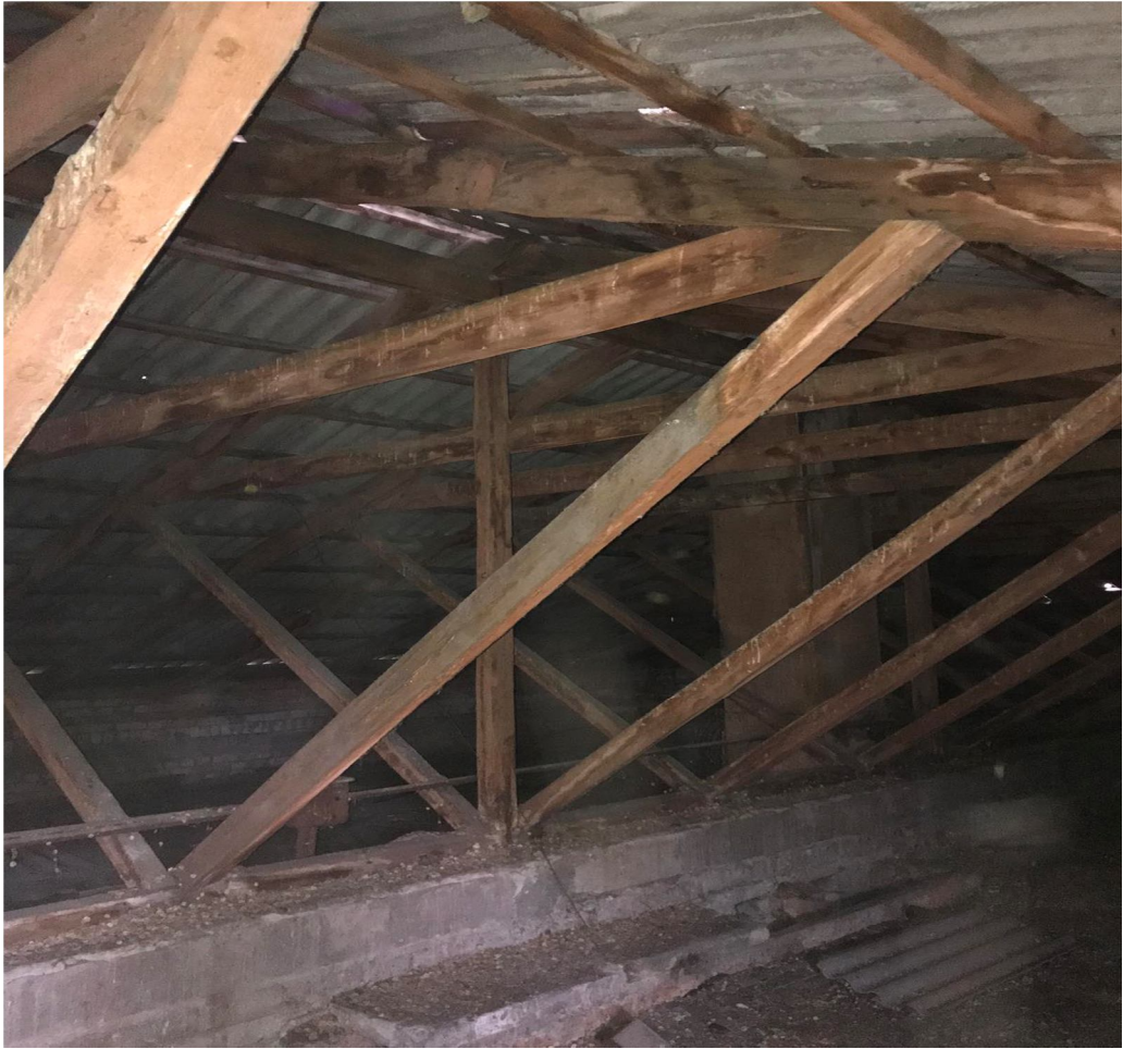
Рисунок 2.23 – Технічний стан дерев'яних елементів покриття.
