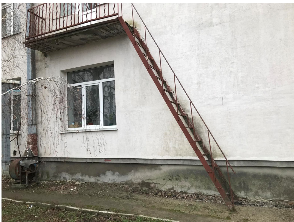
Рисунок 2.18 – Технічний стан евакуаційних сходів будівлі.
