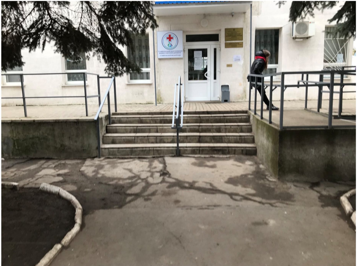
Рисунок 2.27 – Технічний стан ганку головного входу в будівлю.
