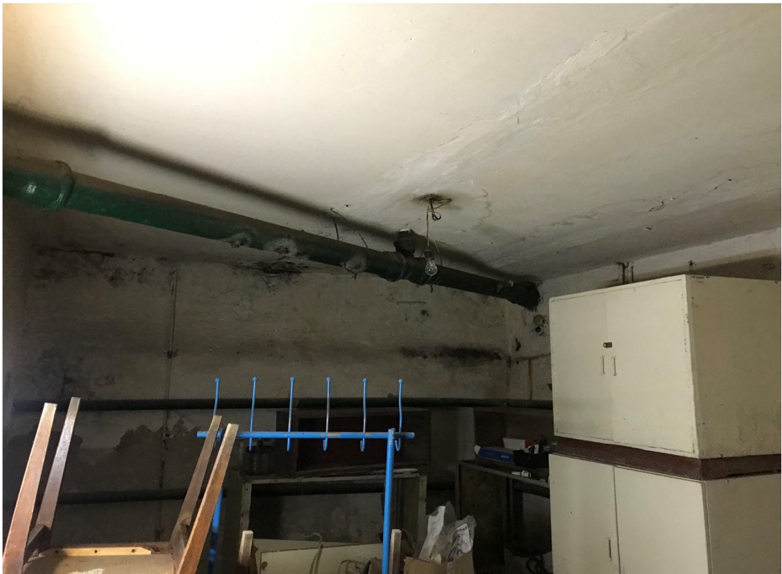
Рисунок 2.8 – Технічний стан плит перекриття в підвалі.
