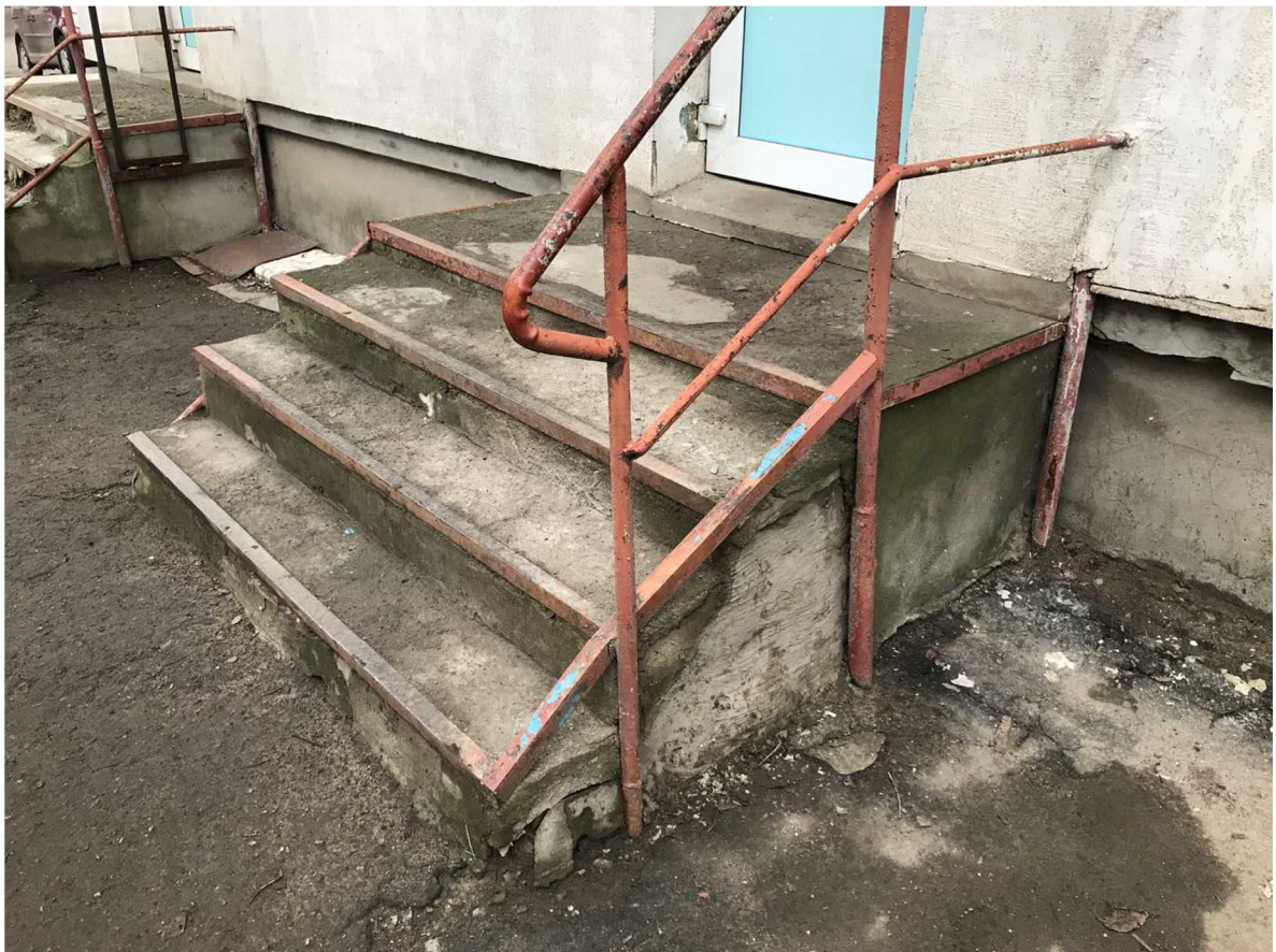
Рисунок 2.28 – Технічний стан ганків входу з бокового фасаду будівлі.
