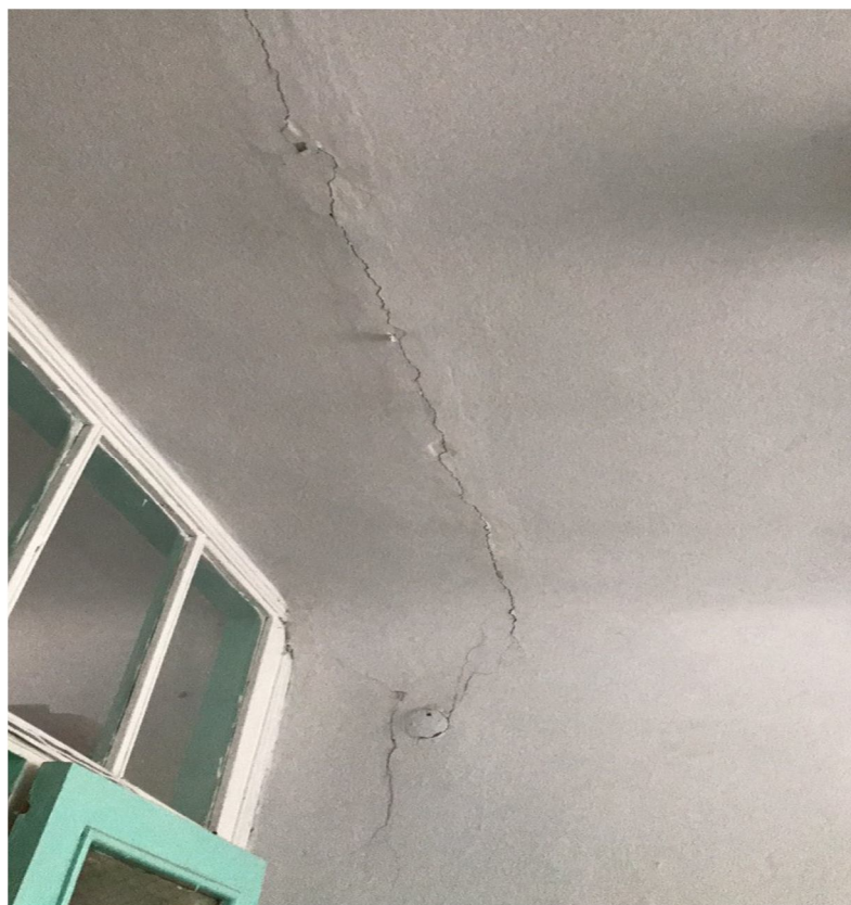
Рисунок 2.34 – Тріщина у внутрішній стіні та розкриття швів між плитами перекриття.
