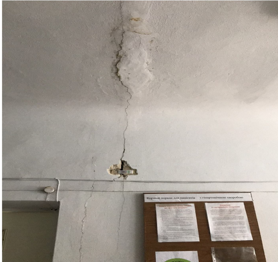
Рисунок 2.37 - Похила тріщина в стіні по вісі 7 з переходом в тріщину у шві між плитами перекриття, замочування шву між плитами перекриття.
