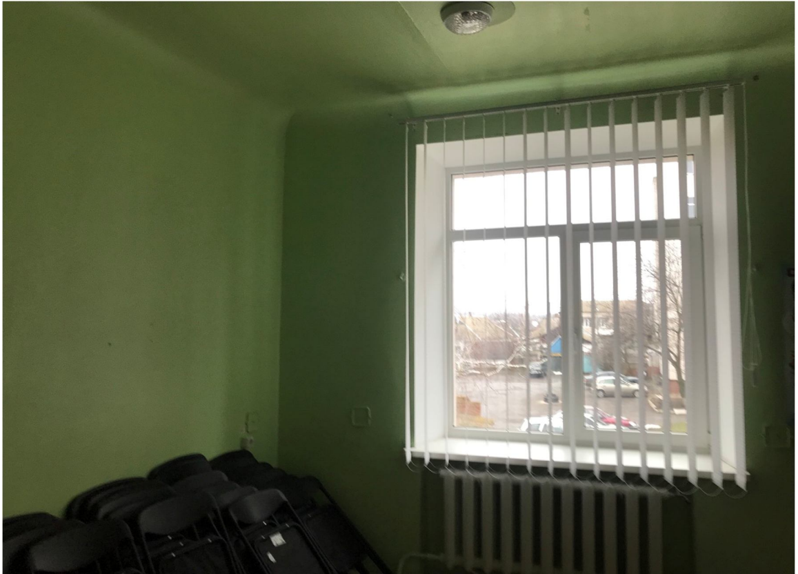
Рисунок 2.11 – Технічний стан зовнішньої стіни, перегородки та вікна в приміщенні актового залу.
