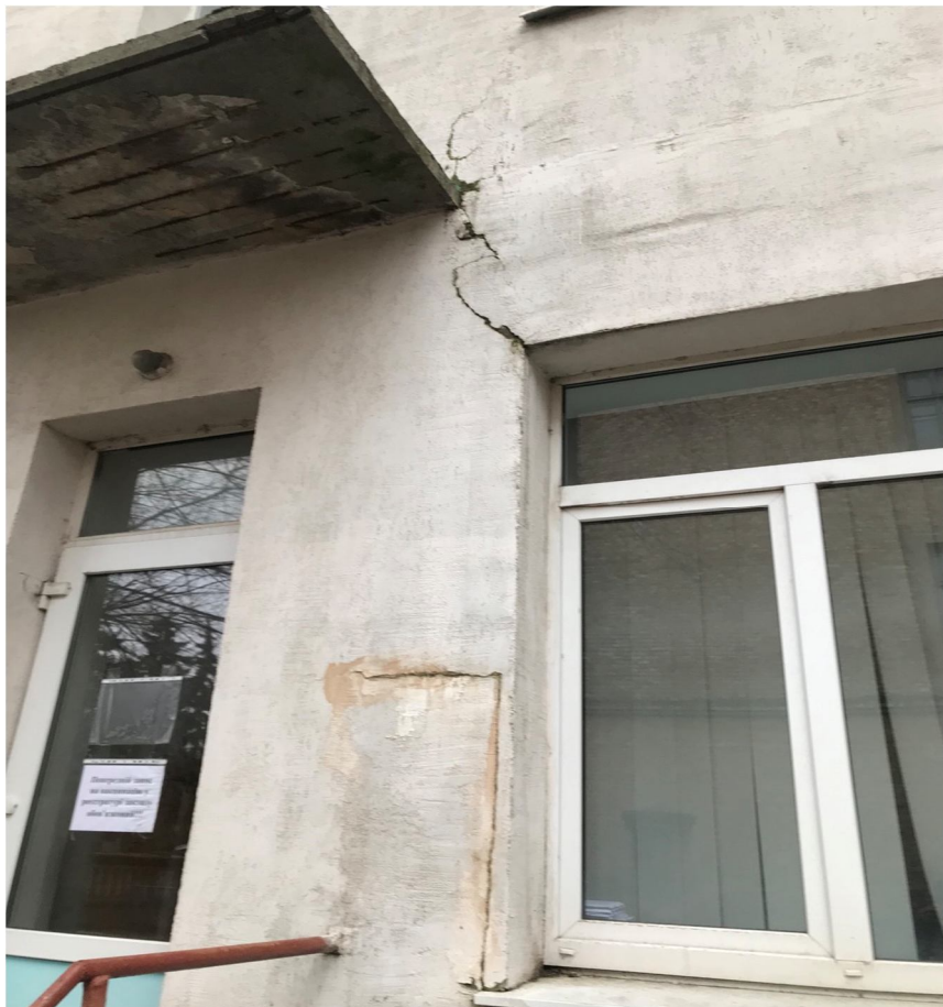
Рисунок 2.29 – Тріщини в зовнішній стіні бокового фасаду будівлі.
