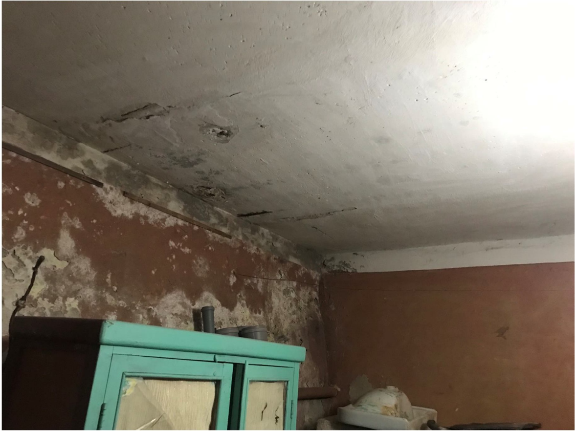
Рисунок 2.31 – Замочування плит перекриття та стіни по ряду Б.
