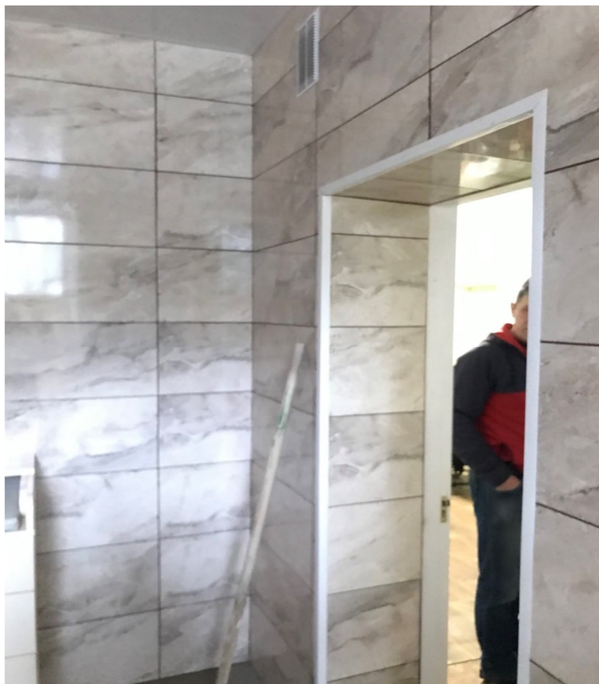
Рисунок 2.14 – Технічний стан внутрішніх стін в приміщенні санвузлу.
