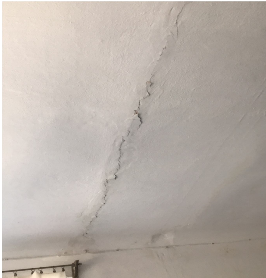
Рисунок 2.38 - Криволінійна тріщина у шві між плитами перекриття.
