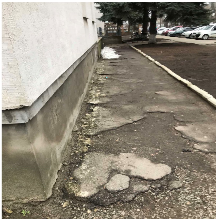
Рисунок 2.30 – Зруйноване вимощення зі сторони головного фасаду будівлі
