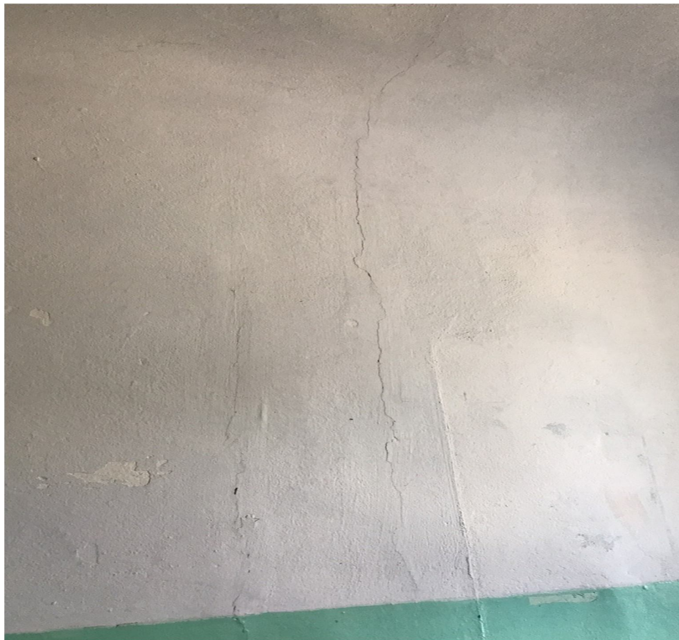
Рисунок 2.33 – Вертикальна тріщина у внутрішній стіні по вісі 7.
