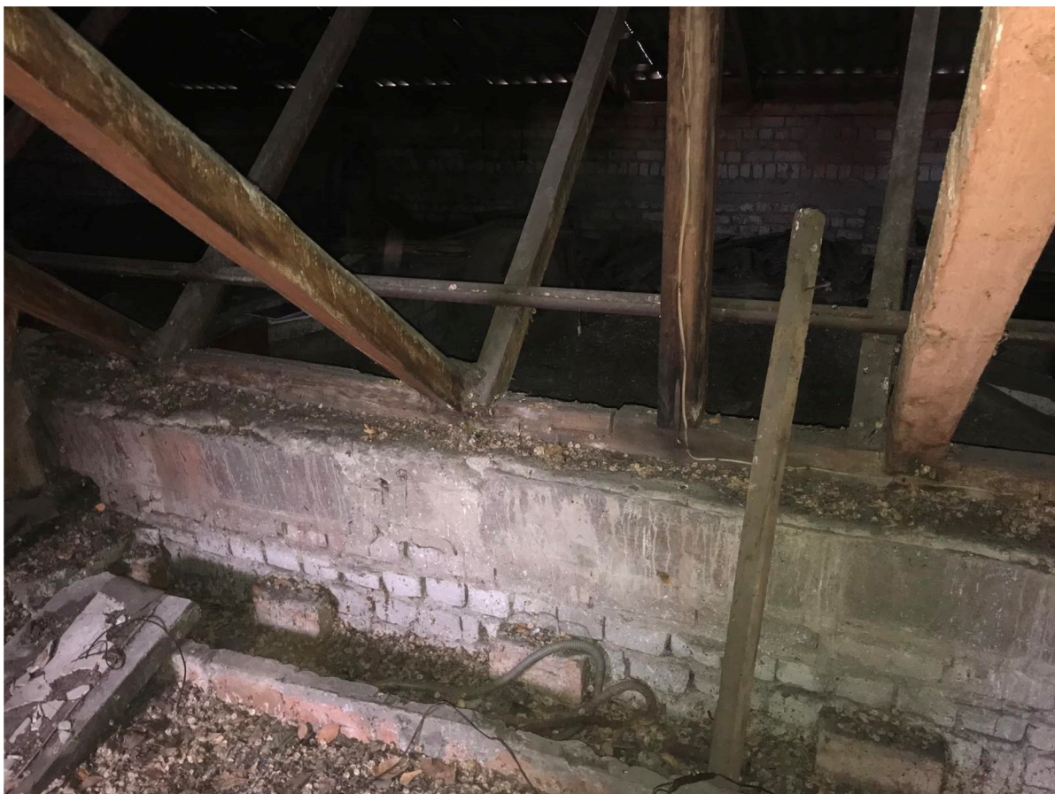
Рисунок 2.22 – Технічний стан внутрішньої стіни та мауерлату.
