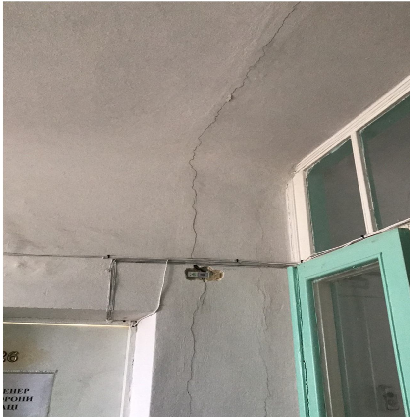
Рисунок 2.35 - Вертикальна тріщина в стіні по вісі 7 з переходом в тріщину у шві між плитами перекриття з шириною розкриття до 5 мм.
