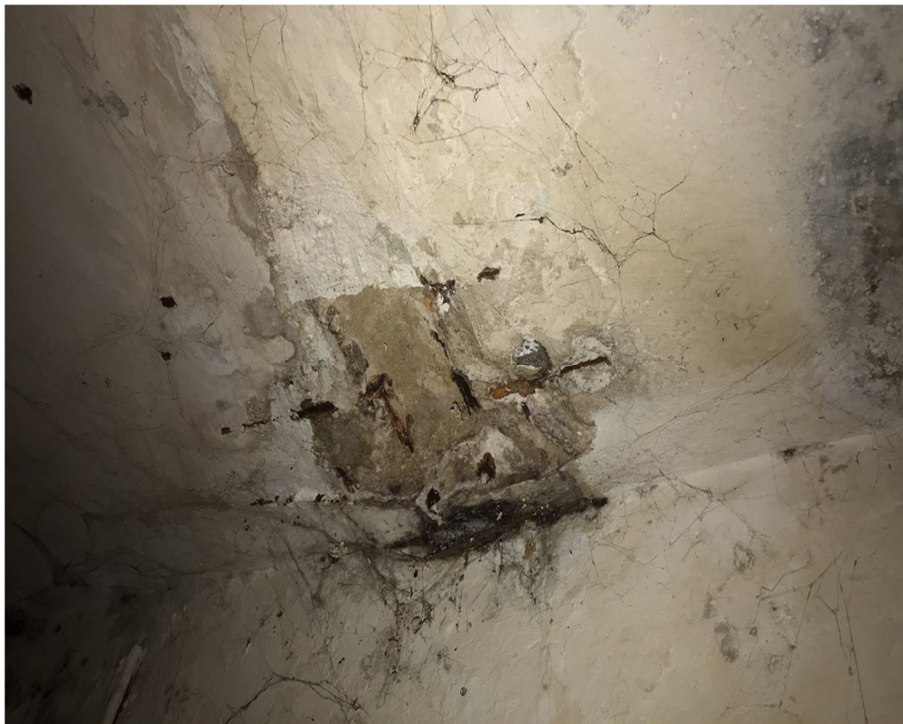
Рисунок 2.32 – Замочування та оголошення арматури в плитах перекриття у стіни по ряду Б.
