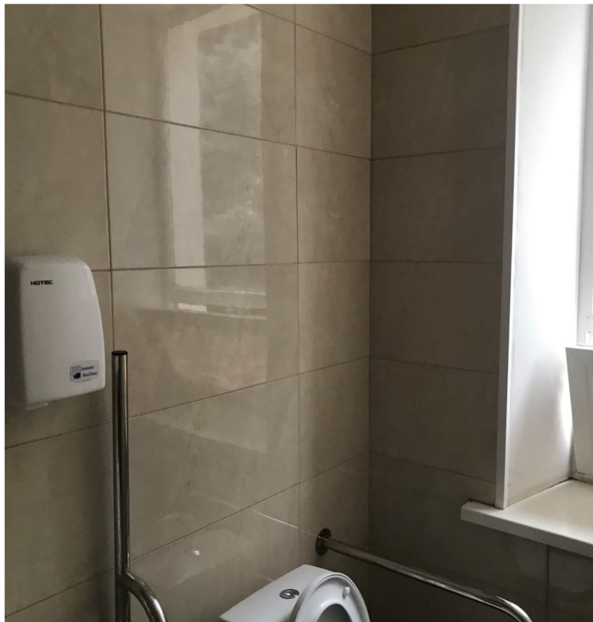
Рисунок 2.12 – Технічний стан зовнішньої та внутрішньої стін в приміщенні санвузла.
