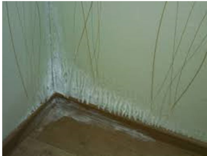
Рисунок 2.1 - Теплова відмова внаслідок внутрішнього утеплення стіни
