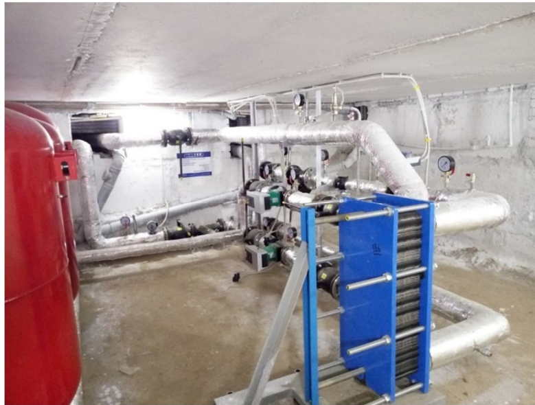
Рисунок 1.9-Індивідуальний тепловий пункт ІТП
