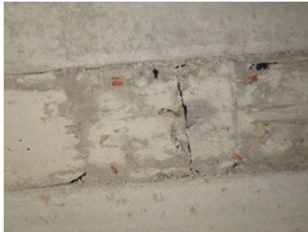
Рисунок 3.10 - Трiщина у залiзобетоннiй монолiтнiй плитi перекриття
