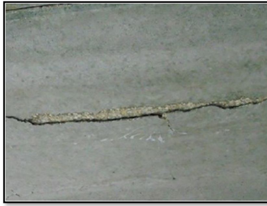
Рисунок 3.13 - Поздовжня тріщина вздовж робочої арматури плити перекриття
