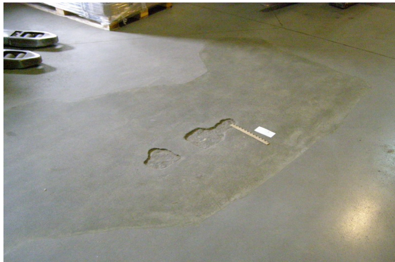
Рисунок 2.18 – Вибоїни бетонної плити підлоги в одному з діючих мегамаркетів м. Харкова
