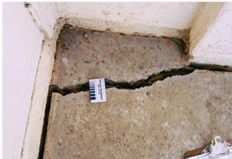
Рисунок 2.19 – Наскрізна тріщина бетонної плити підлоги
