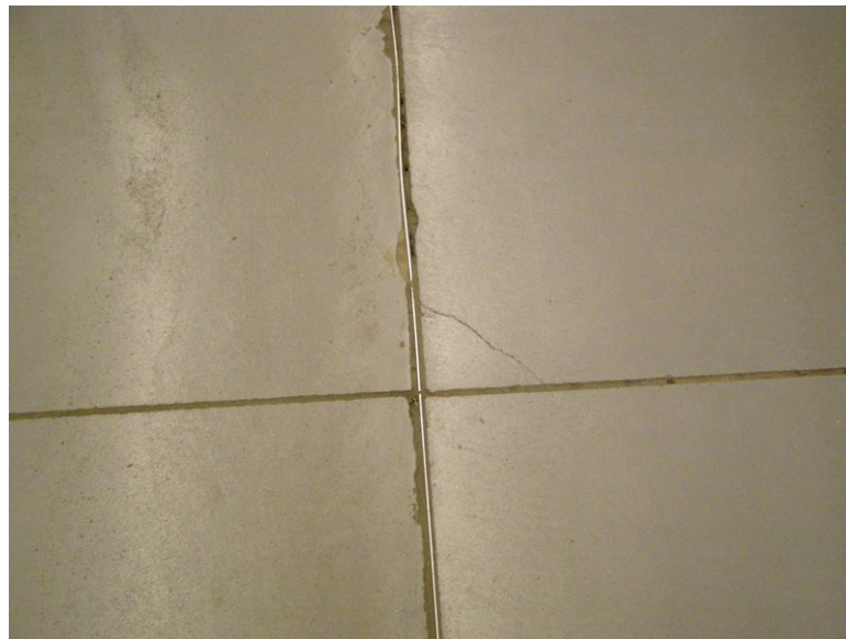
Рисунок 2.23 – Відколи кутів і країв бетонної плити підлоги
