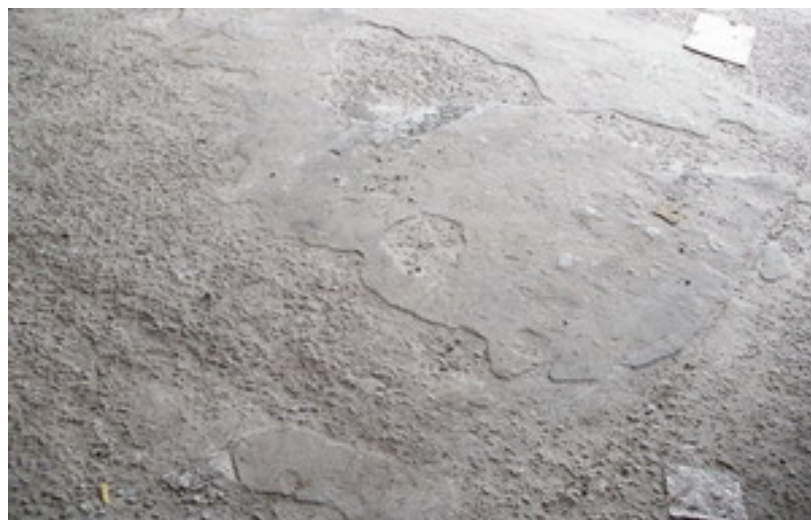
Рисунок 2.17 – Лущення бетонної плити підлоги
