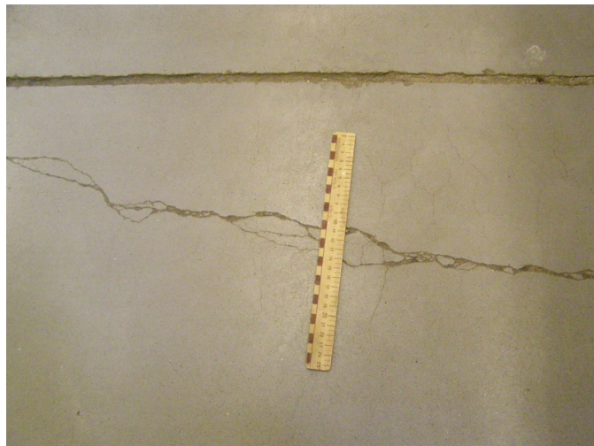
Рисунок 2.20 – Косі тріщини бетонної плити підлоги
