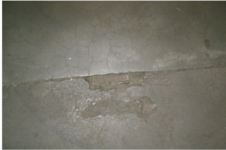
Рисунок 2.22 – Волосяні тріщини, вибоїни й відшарування крайок шва плити підлоги
