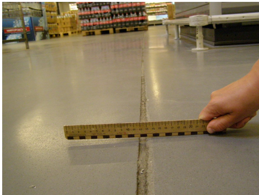
Рисунок 2.25 – Уступи між плитами підлоги
