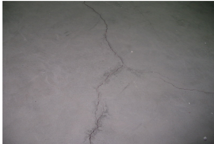
Рисунок 2.21 – Поверхневі тріщини бетонної плити підлоги
