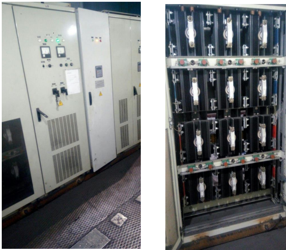
Рисунок 3.4 – Загальний вигляд тиристорного перетворювача типу ТКЕ
