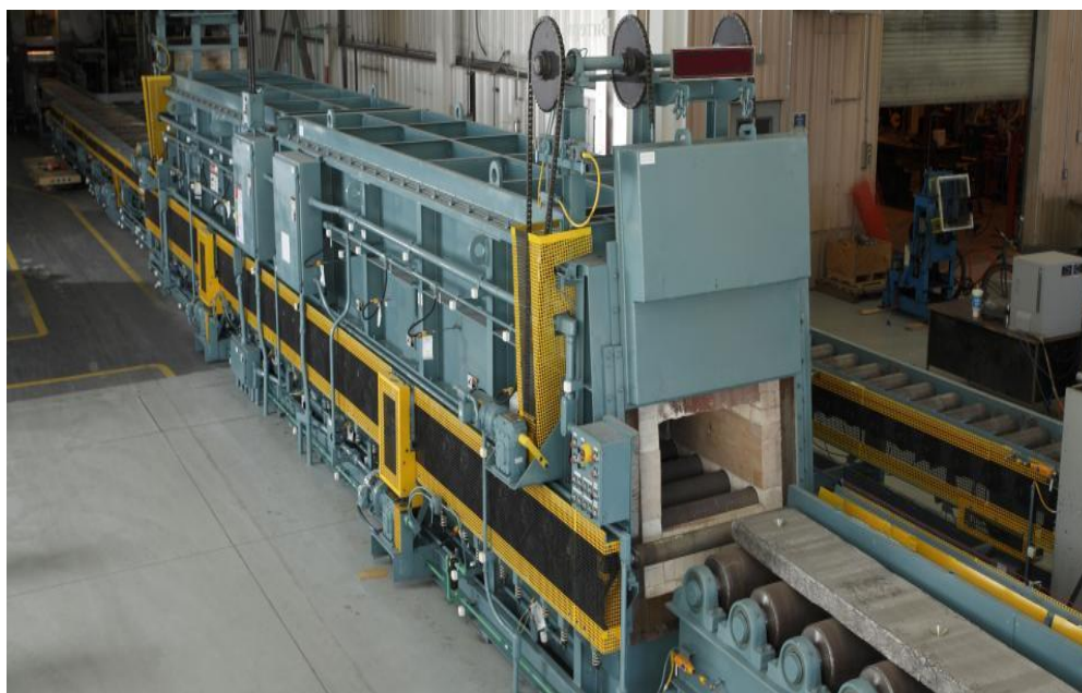
Рисунок 1.4. Загальний вигляд прохідної печі
