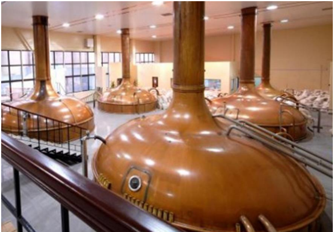
Рисунок 2.5 – Запорізький пивоварний завод, варильний цех
