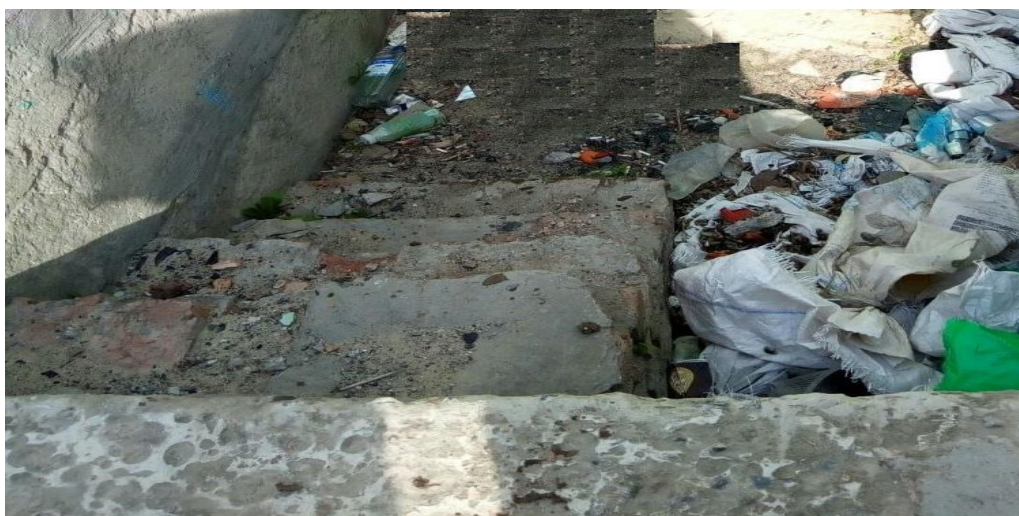
Рисунок 1.10 – Фрагмент пошкодження сходів в техпідвал
