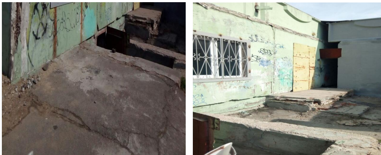
Рисунок 1.5 – Фрагмент пошкодження вимощення
