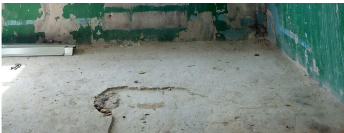
Рисунок 1.7 – Фрагмент пошкодження підлоги
