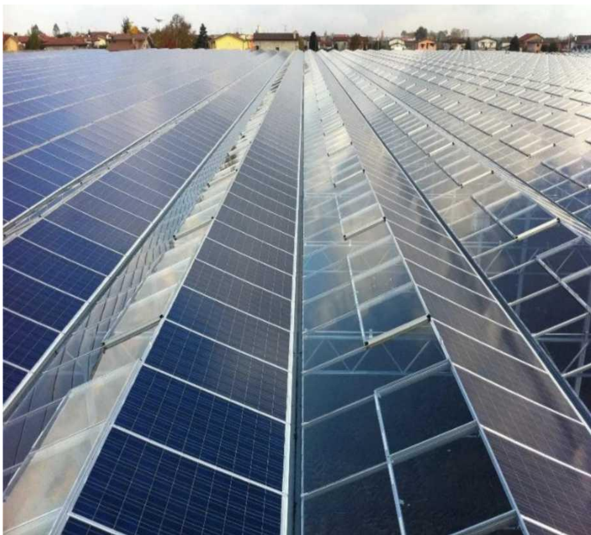
Рисунок 2.5 - Фотоелектричні панелі на покрівлі будівлі
