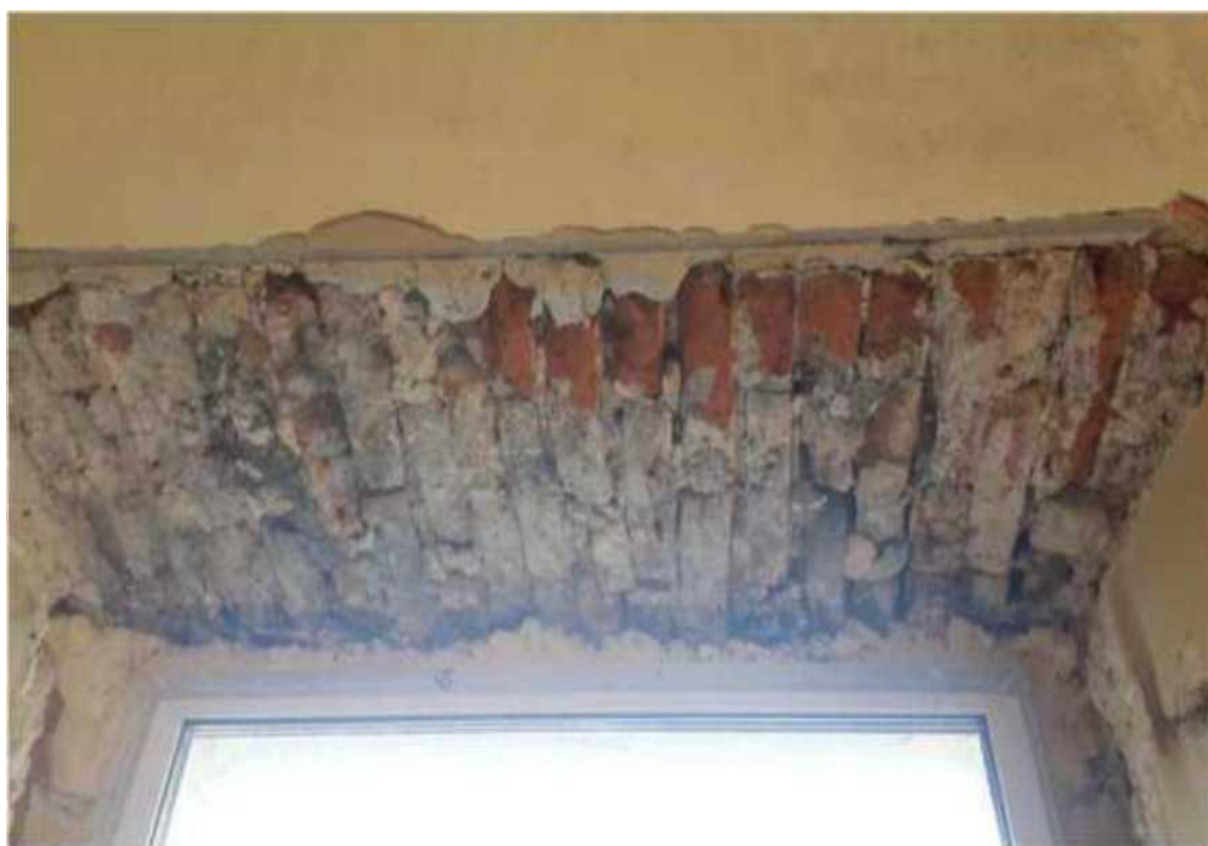
Рисунок 2.2 - Руйнування цегляної кладки клинчастої перемички
