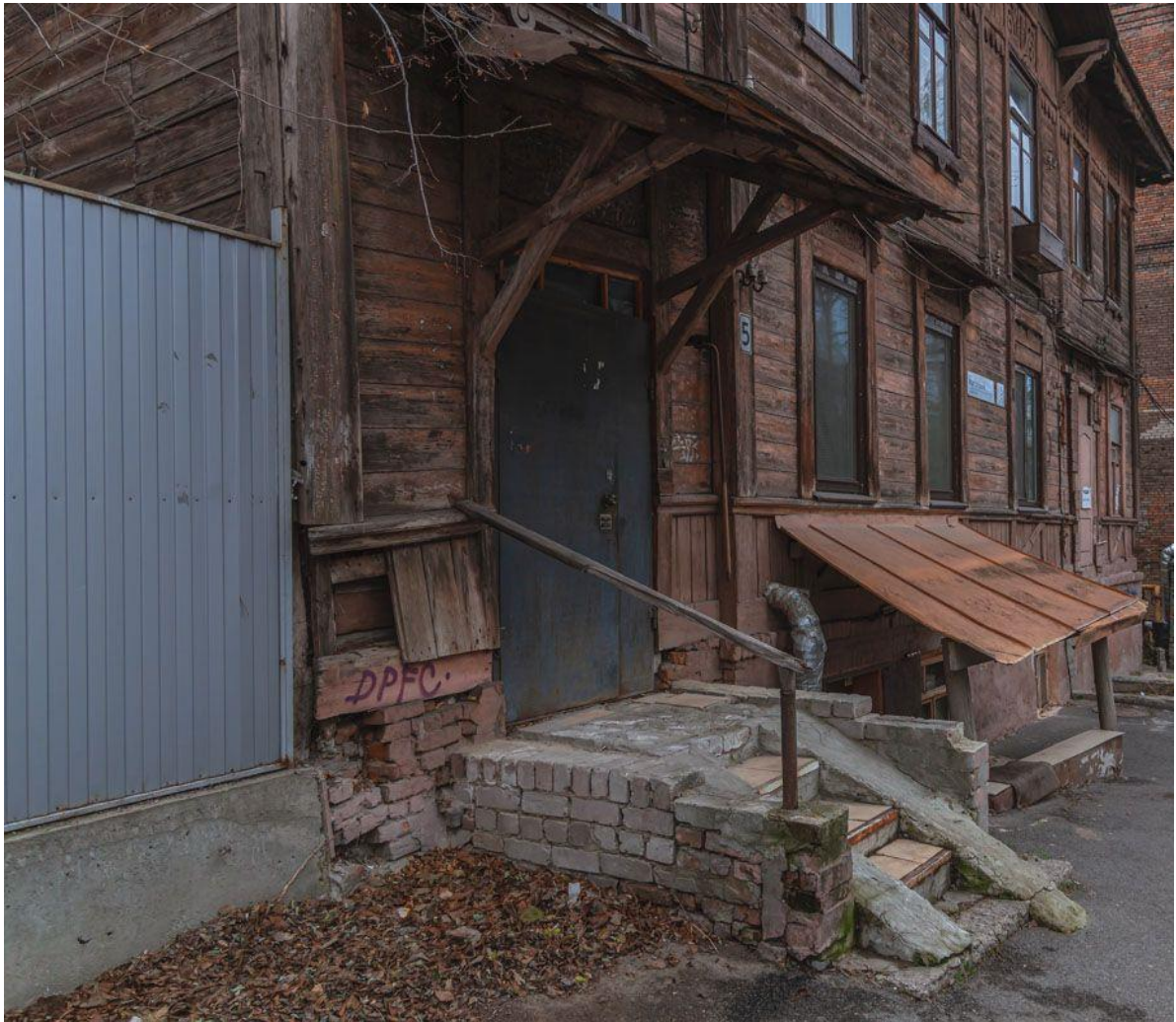
Рисунок 2.18 - Дефекти фундаменту і отмостки будівлі.
