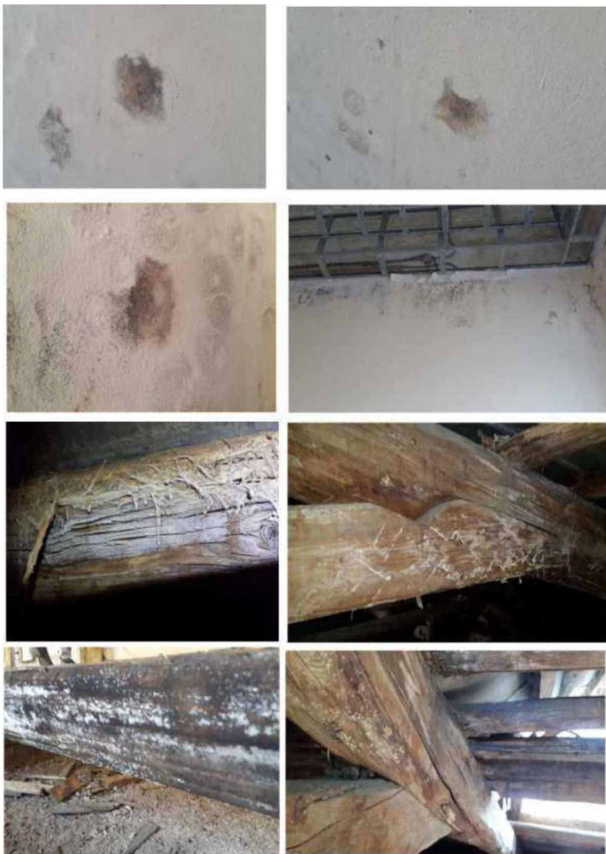
Рисунок 2.11 - Сліди біопшкодження деревини та розвитку плісняви на поверхні штукатурки
