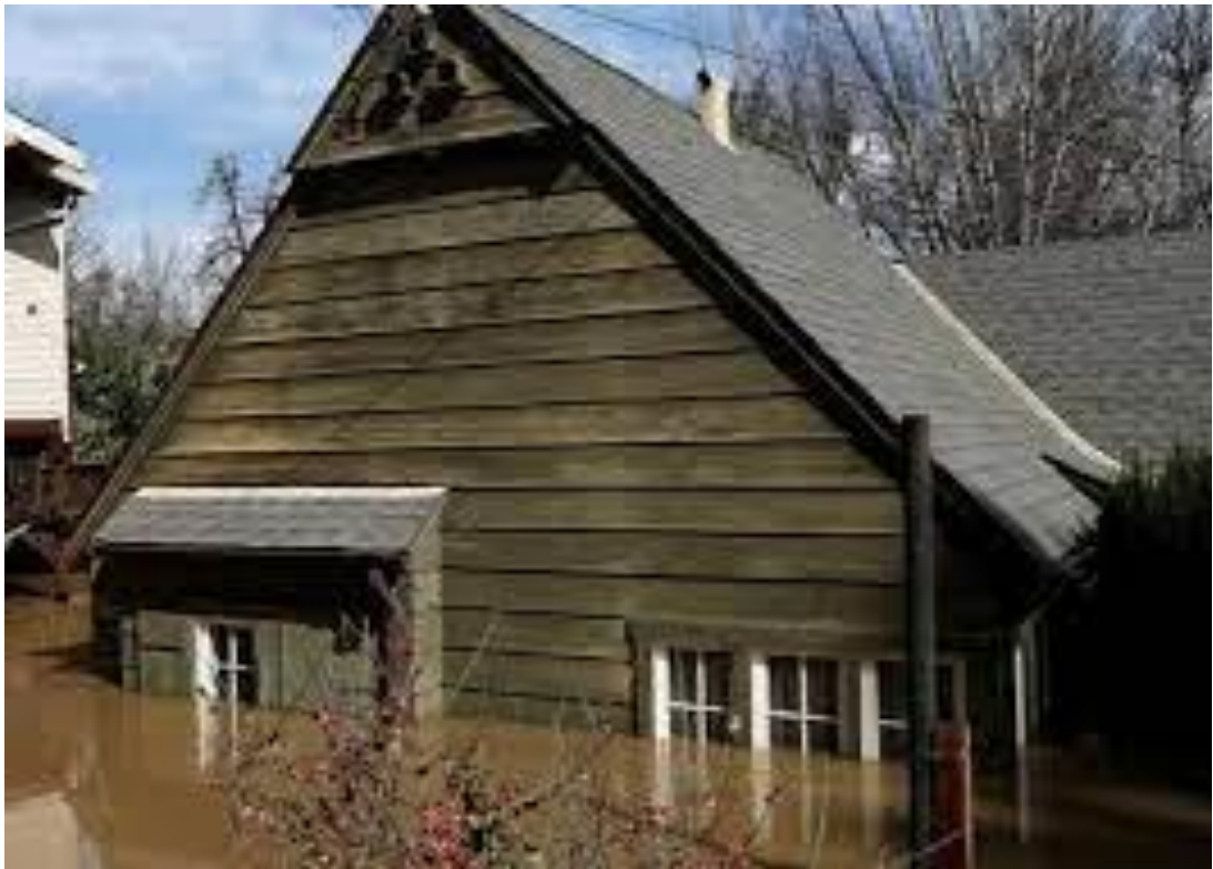
Рисунок 3.6 - Пошкодження внаслідок повені дерев'яної будівлі
