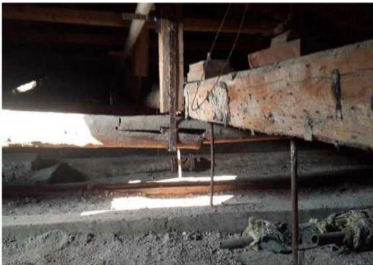
Рисунок 2.9 - Розрив затяжки, викривлення підвісів кроквяної системи
