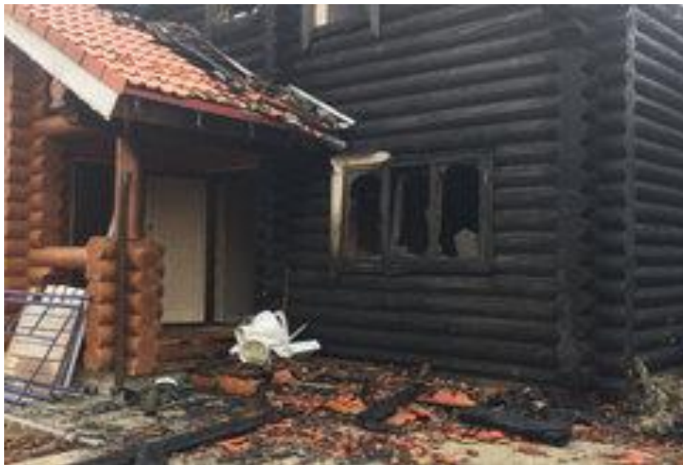
Рисунок 3.5 - Пошкодження внаслідок пожежі дерев'яної будівлі
