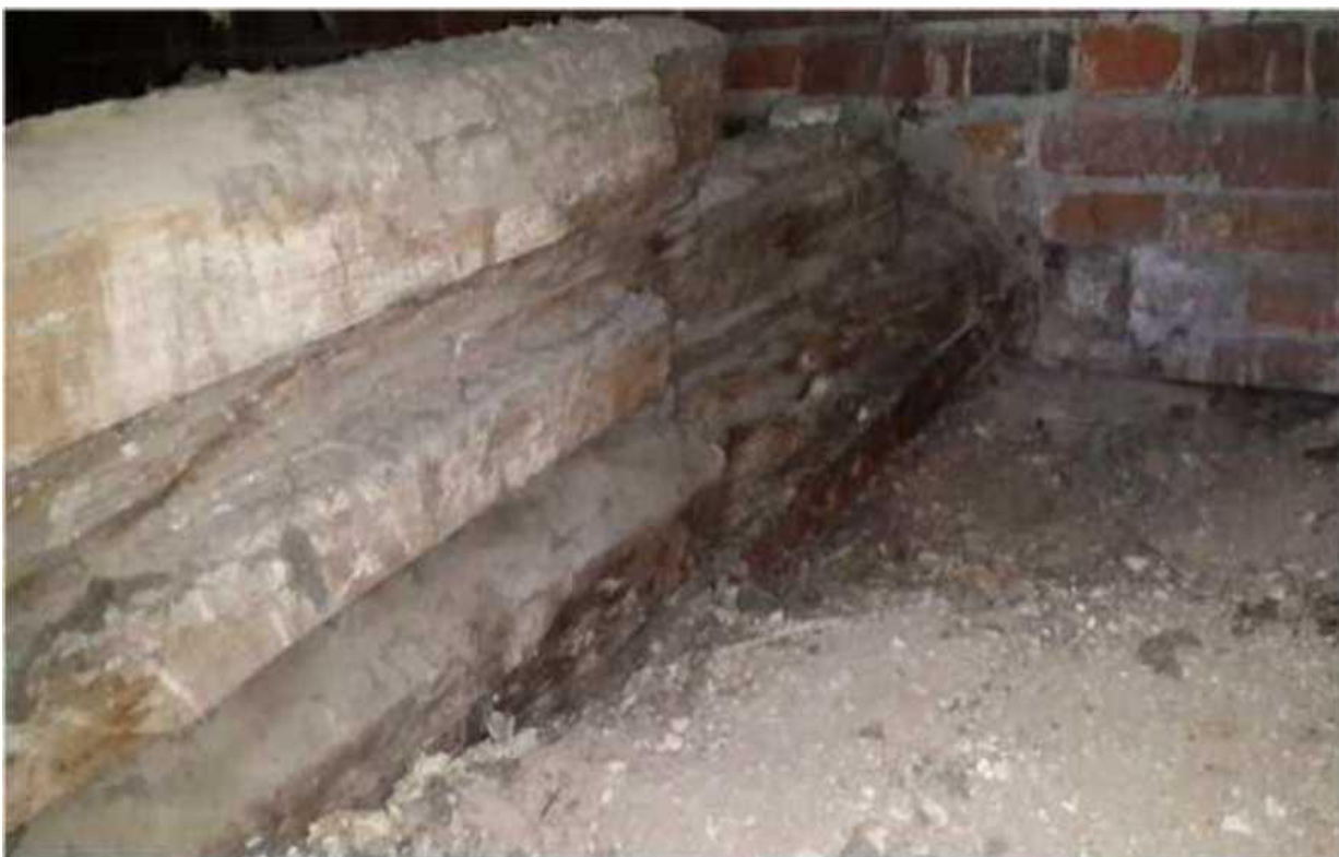
Рисунок 2.5 – Гнило опорних кінців дерев'яних балок горищного покриття
