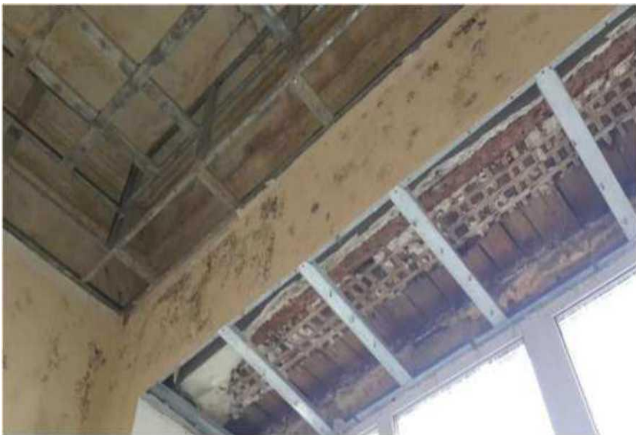
Рисунок 2.3 - Руйнування надоконної перемички
