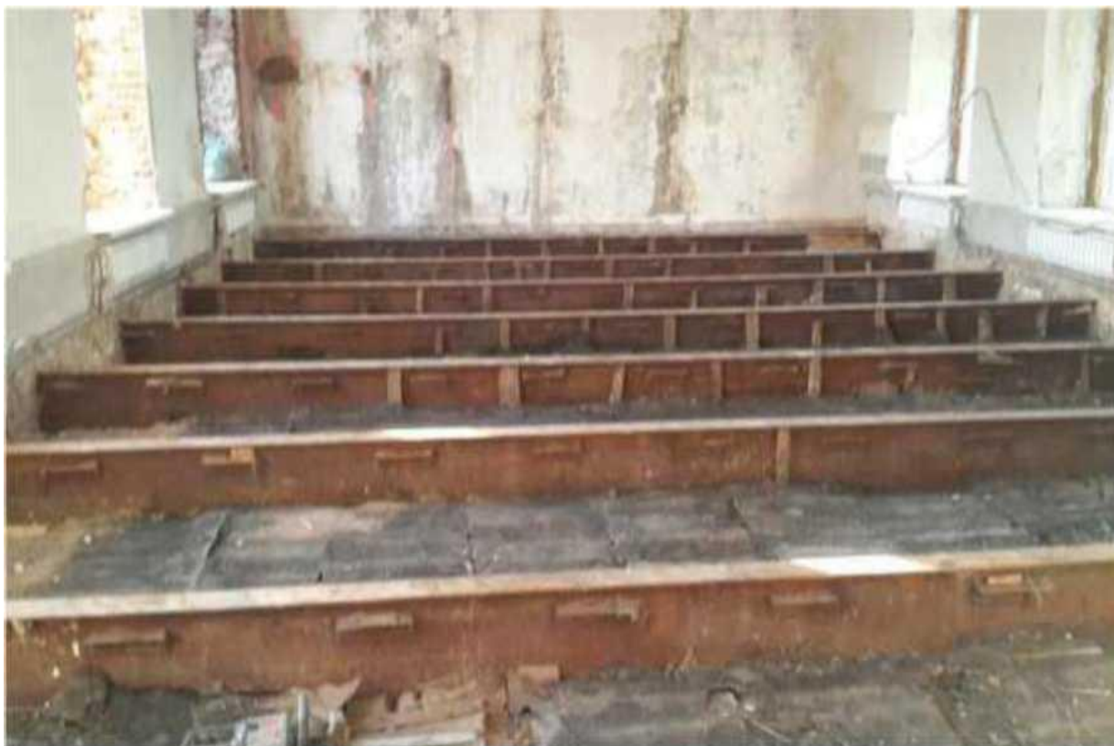
Рисунок 2.1 - Переkritтя над 1-м поверхом, корозія сталевих балок
