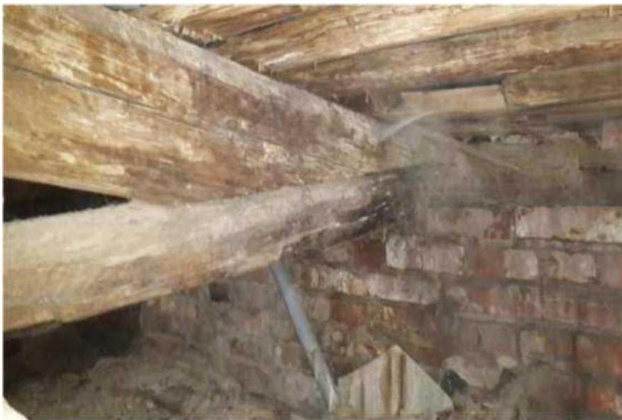
Рисунок 2.6 - Гнилі опорних кінців кроквяних ніг та мауерлату
