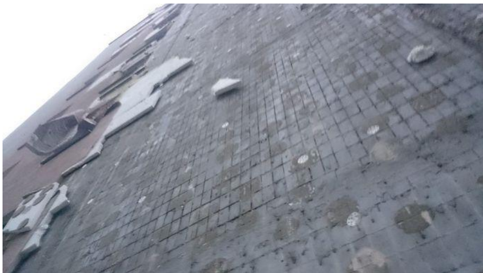
Рисунок 1.11 – обвалення утеплювача з неочищеного фасаду
