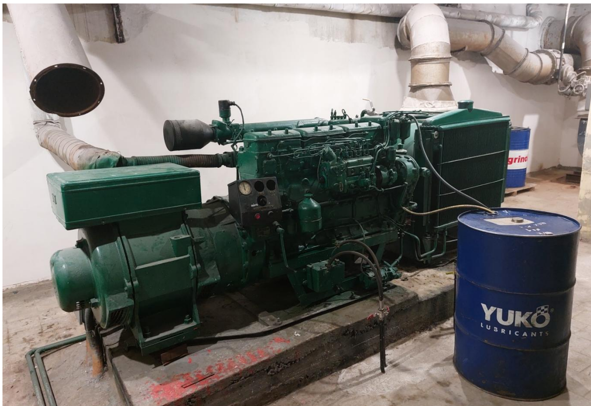
Рисунок 2.24 – Стаціонарна дизельна електростанція
