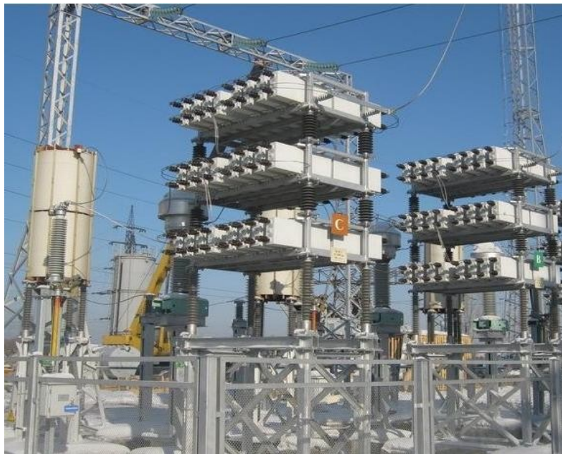
Рисунок 2.11 – Зовнішній вигляд силових конденсаторів на підстанції
