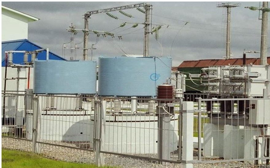
Рисунок 2.17 – Зовнішній вигляд силової установки фільтрації гармонік та компенсації реактивної потужності
