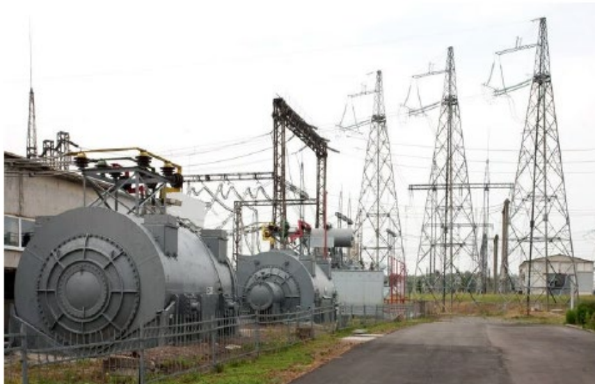
Рисунок 2.6 – Зовнішній вигляд синхронних компенсаторів на підстанції
