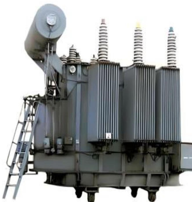
Рисунок – 2.1 Трансформатор ТДНС-10000/35-У1
