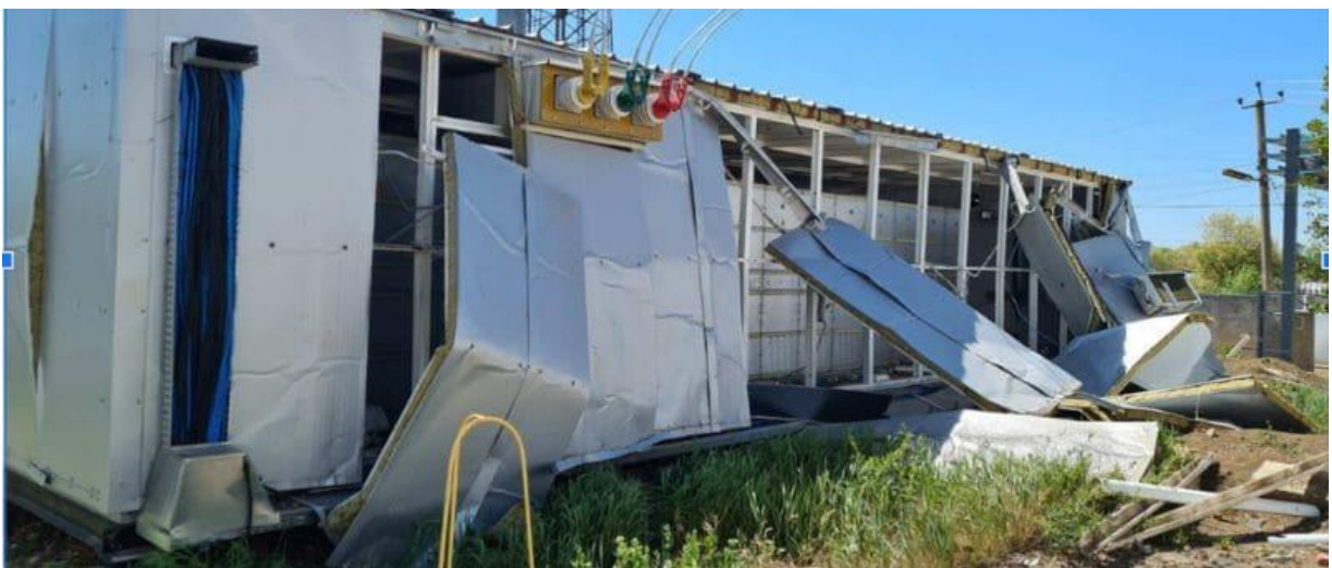
Рисунок 3.15 - Електрична підстанція. Вибуховою хвилею зруйновані стіни будівлі. Обладнання не постраждало та зберегло працездатність.
