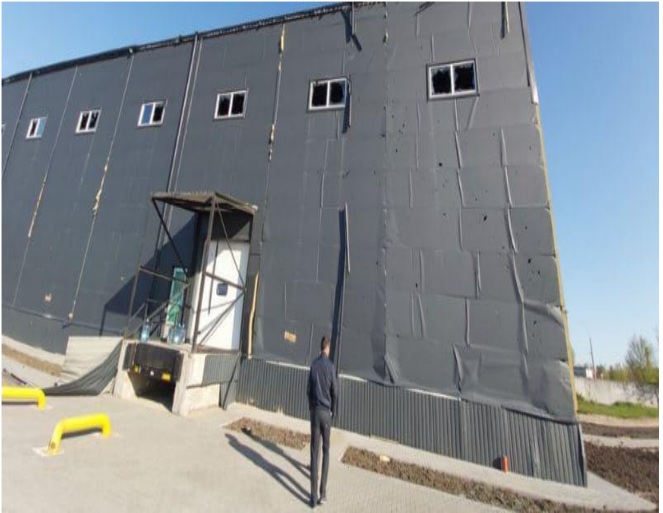
Рисунок 3.16 - Склад в Київській області. Внаслідок вибуху було пошкоджено стіни уламками від цистерн з нафтопродуктами.
