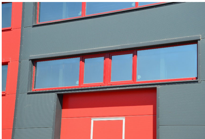
Рисунок 2.1 – Приклад металопластикових виробів в цеху з офісом у м. Запоріжжя, вул. Николая Краснова, 20
