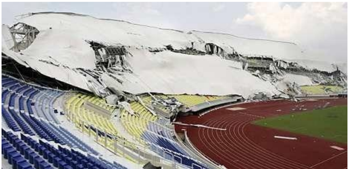
Рисунок 1.24 - Аварії покриттів над трибунами стадіонів: а - стадіон футбольного клубу Твенте в Голландії; б - стадіон в Майлазії.
