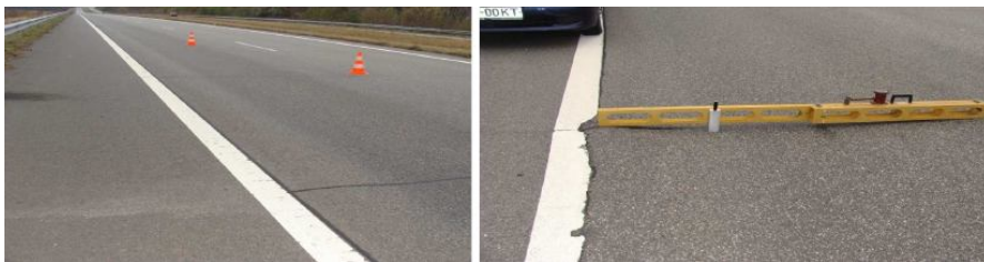
Рисунок 1.2 – Колія в асфальтобетонному покритті на жорсткій основі на автомобільній дорозі
