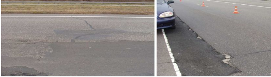
Рисунок 1.1 – Розшарування асфальтобетонного шару і цементобетонної плити на автомобільній дорозі
