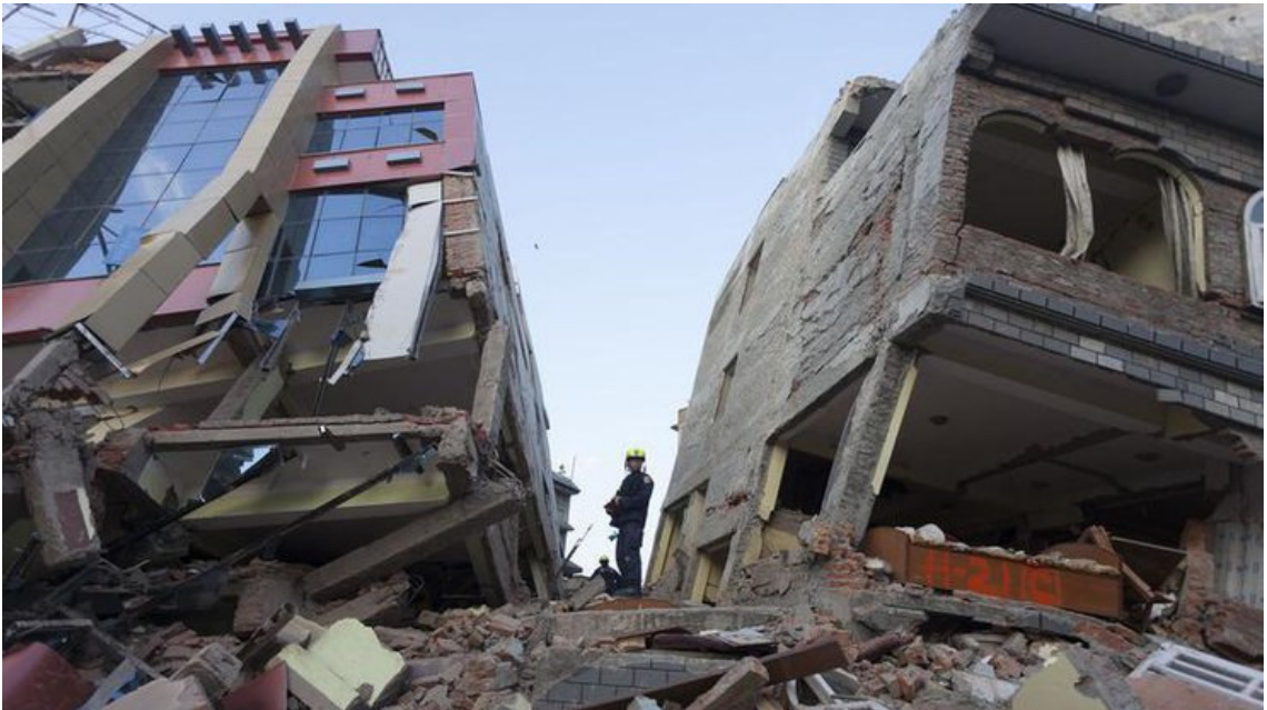
Рисунок 1.5 – Обрушення будинків в Індії в ущільненій забудові
