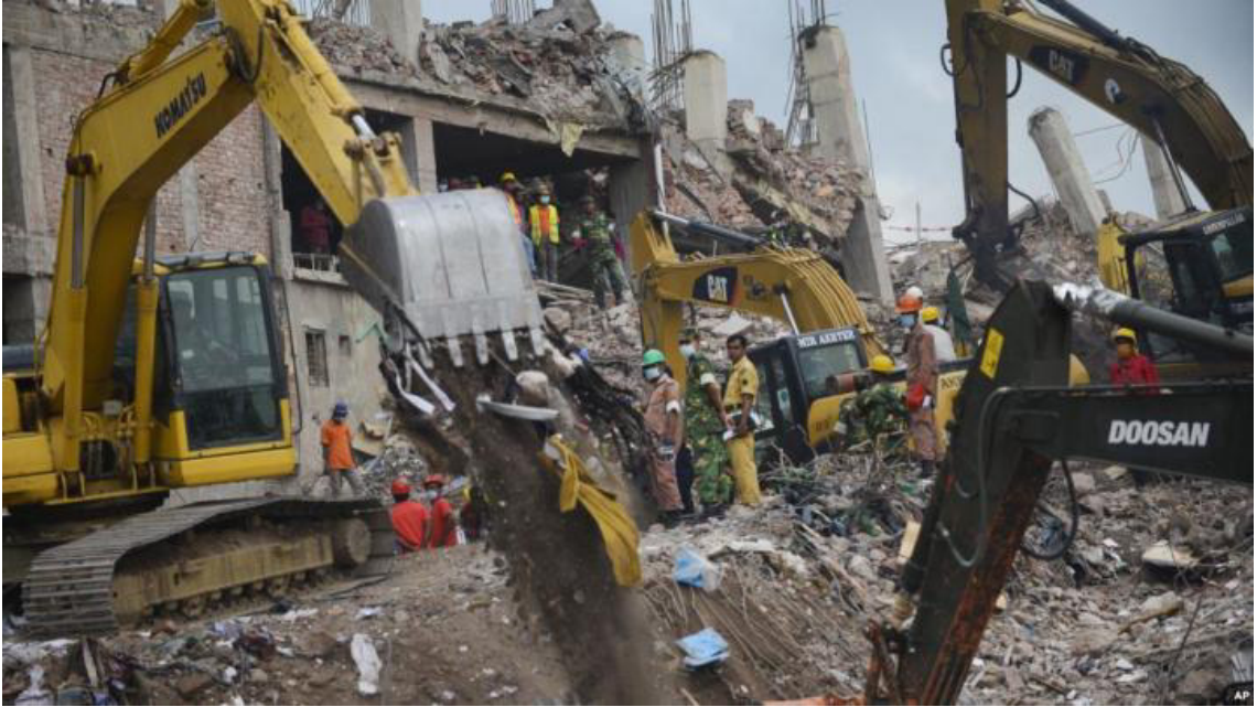
Рисунок 1.18 – Наслідки обрушення будівлі
