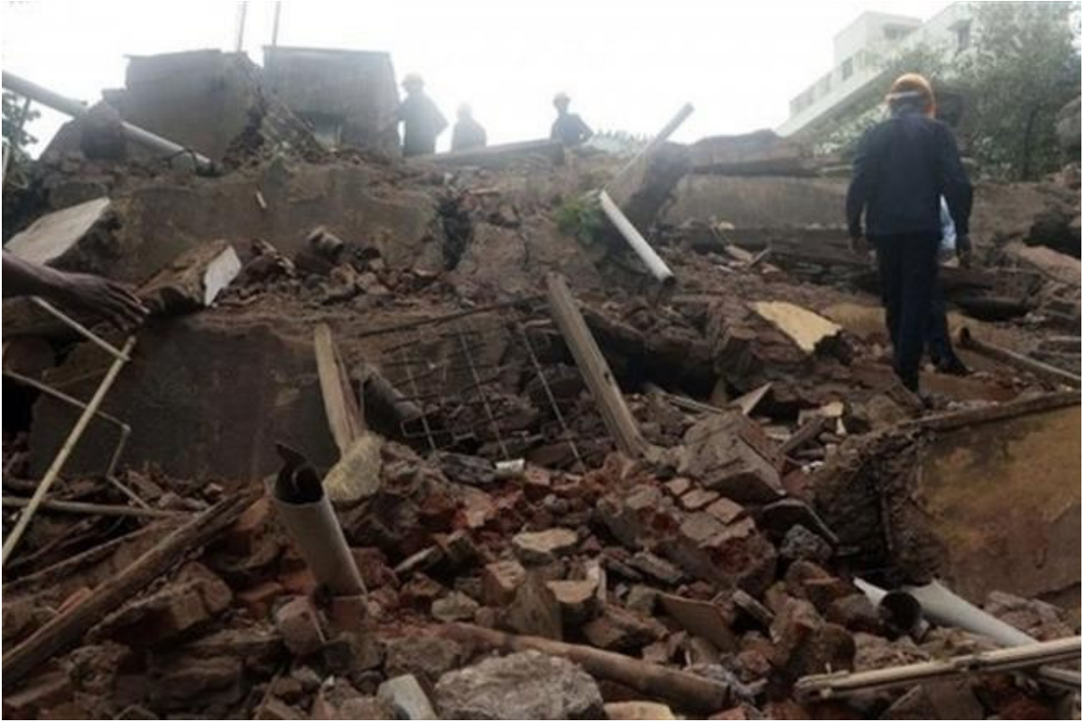
Рисунок 1.2 – Наслідки обрушення будинку в Індії
