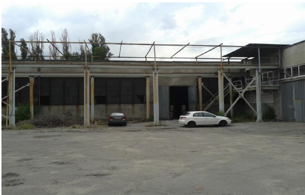
Рисунок 2.9 – Технічний стан металевої прибудови.
