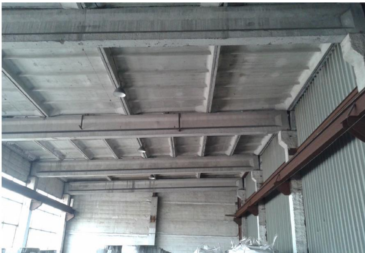
Рисунок 2.6 – Технічний стан колон, балок та плит покриття.
