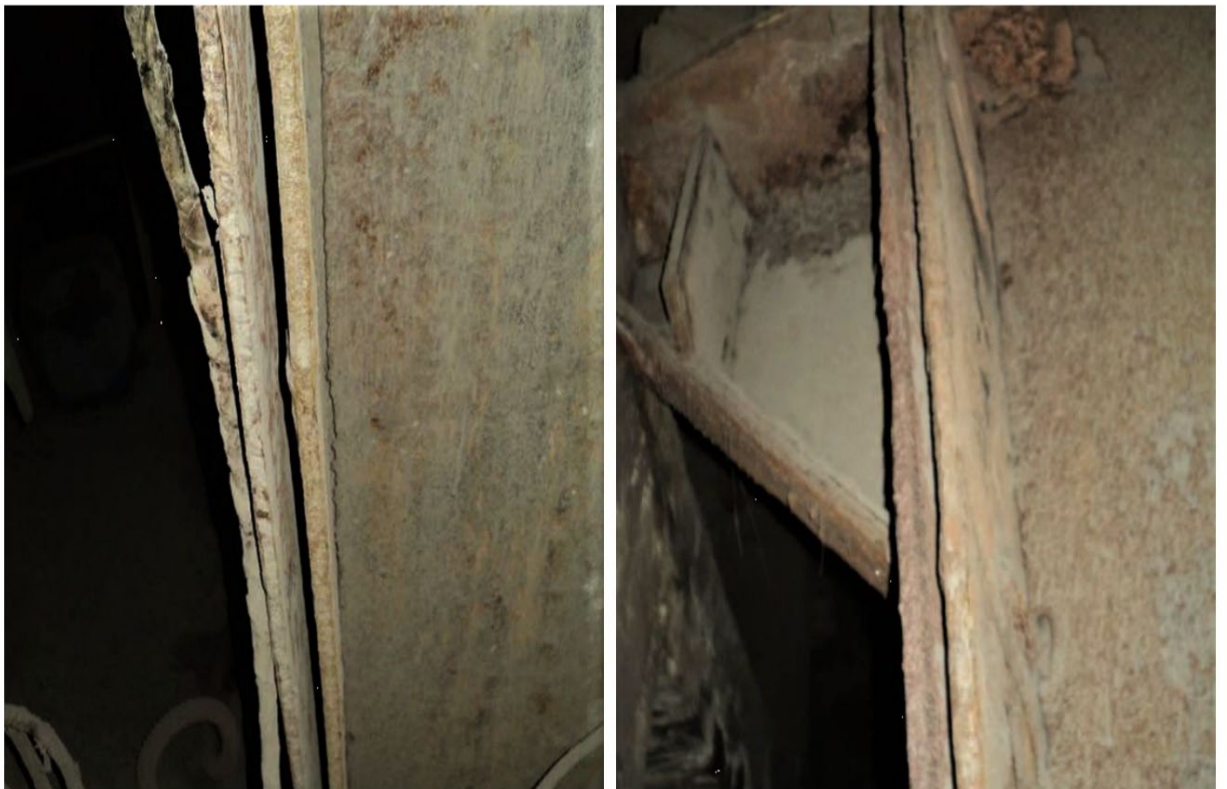
Рисунок 5 – Корозія металу колон
