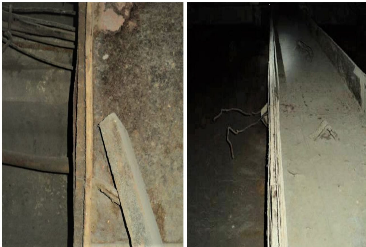
Рисунок 6 – Корозія металу несучих елементів – колон
