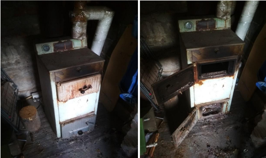
Рисунок 1.6 – Твердопаливний котел КС-Т-16 встановлений у сараї
