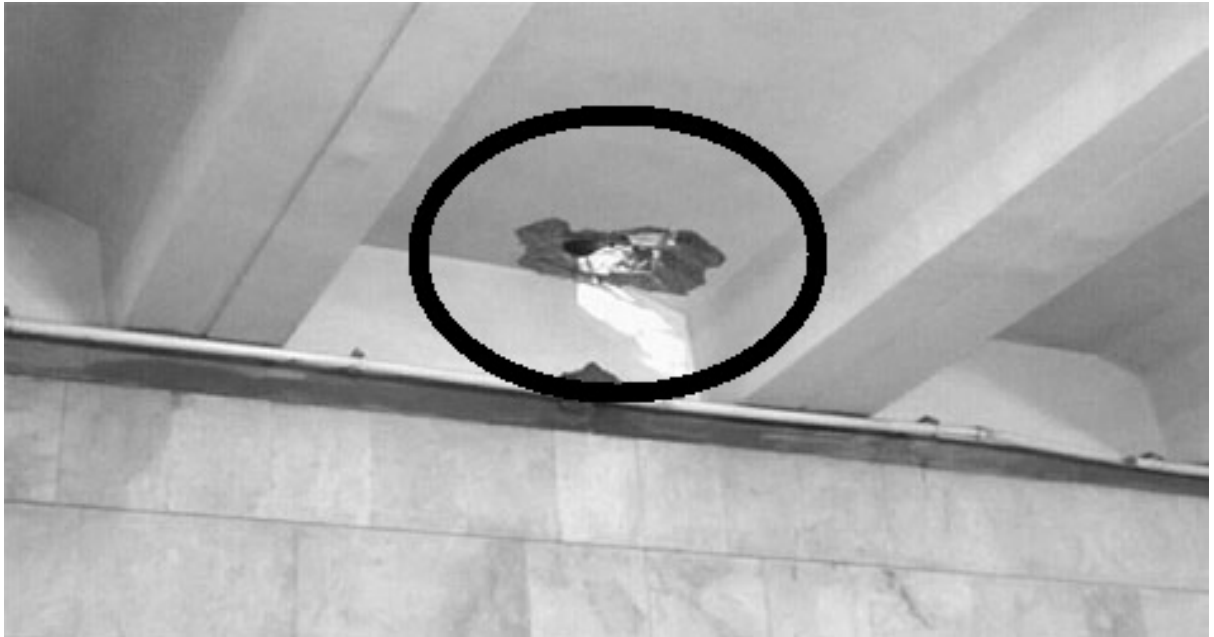
Рисунок 1.2 – Пошкодження конструкцій покриття споруди станції метрополітену
