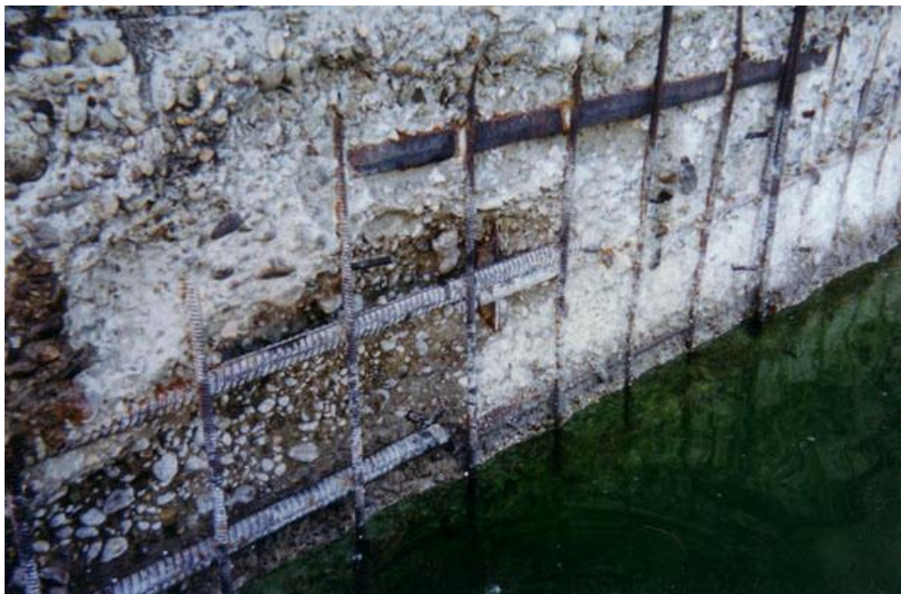
Рисунок 1.6 – Руйнування залізобетонної конструкції під впливом агресивної ВОДИ
