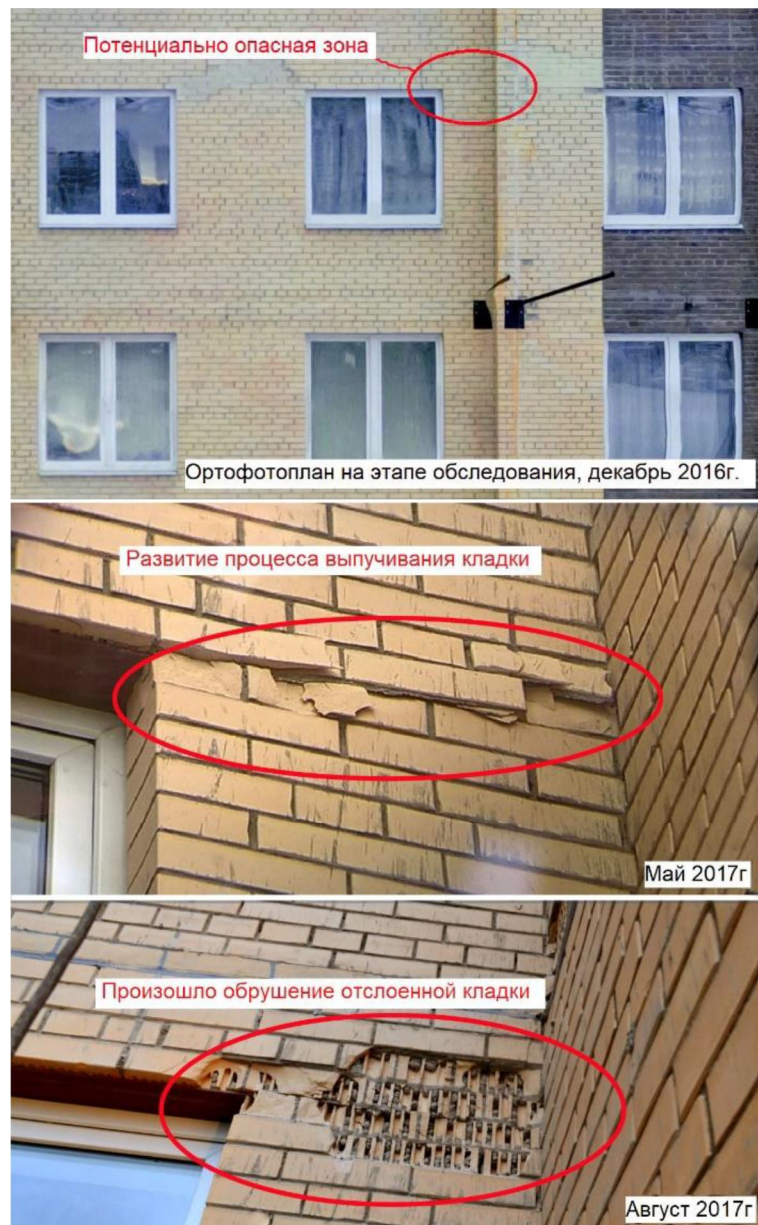
Рисунок 3.23 - Спостереження за проблемною ділянкою цегляної кладки житлового будинку
