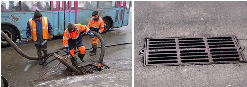
Рисунок 4.1 – Обслуговування системи водовідведення доріг
