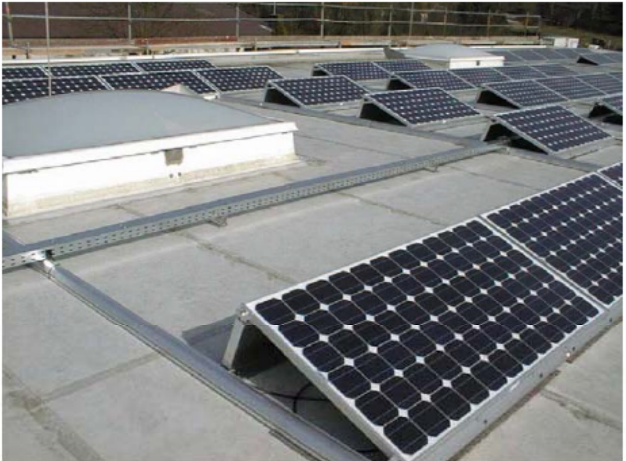
Рисунок 3.5 - Сонячні панелі на даху будівлі з захістним заземленням
